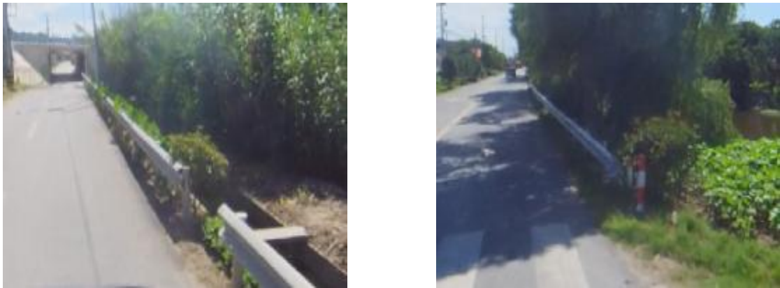
波形护栏端头板面损坏
