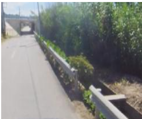
波形护栏端头板面损坏
