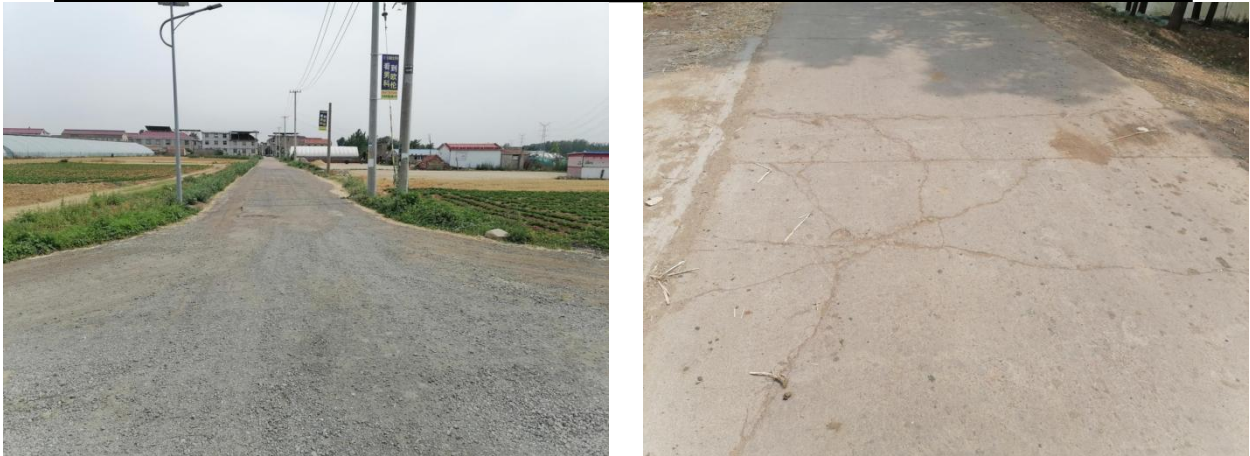
水泥混凝土路面病害
