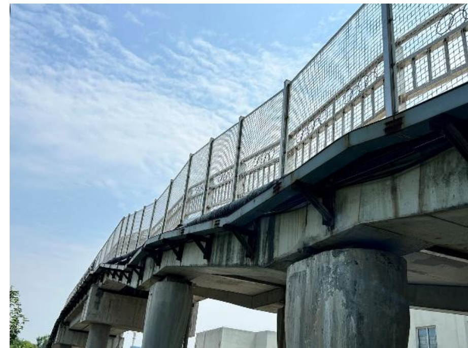
图 5.2-2 现状电缆桥架
