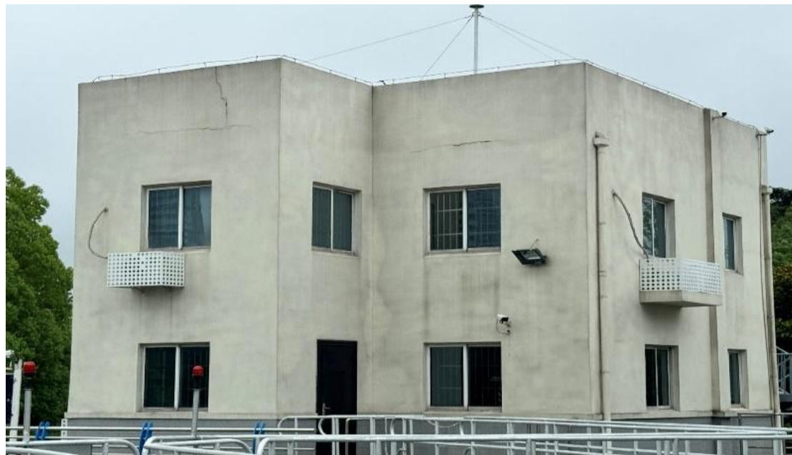
图 4.2-1 启闭机房裂缝图
