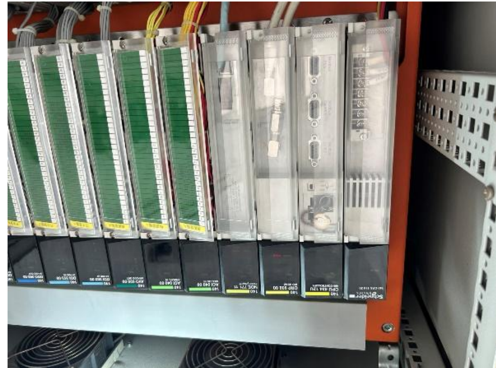
图 5.2-1 现状 PLC 控制系统
