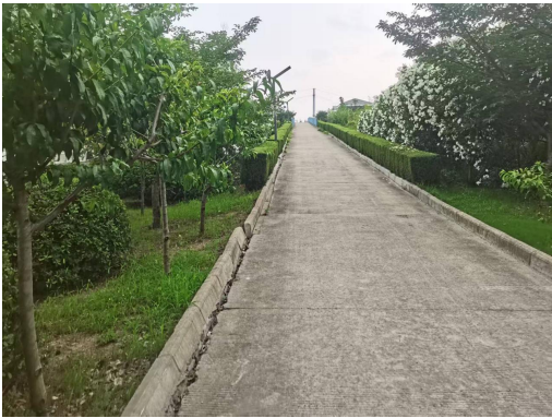
水泥混凝土路面及缘石现状
