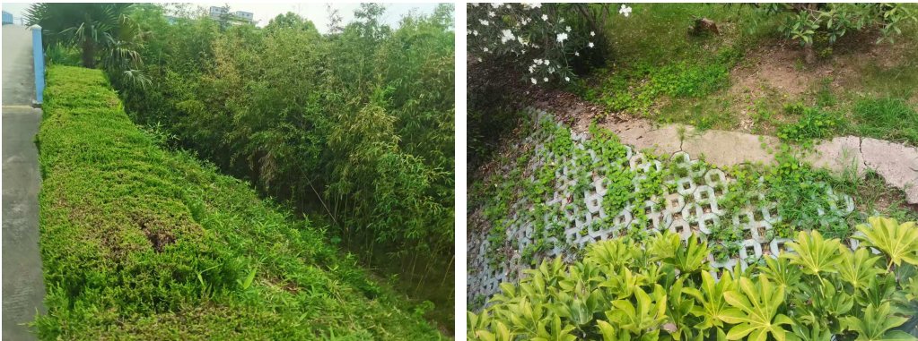
边坡轻微损坏现状现状
