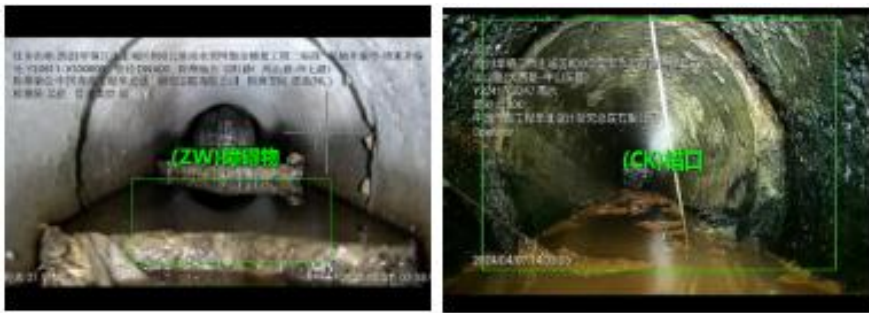
图 5-15 B 类管道缺陷示例图
