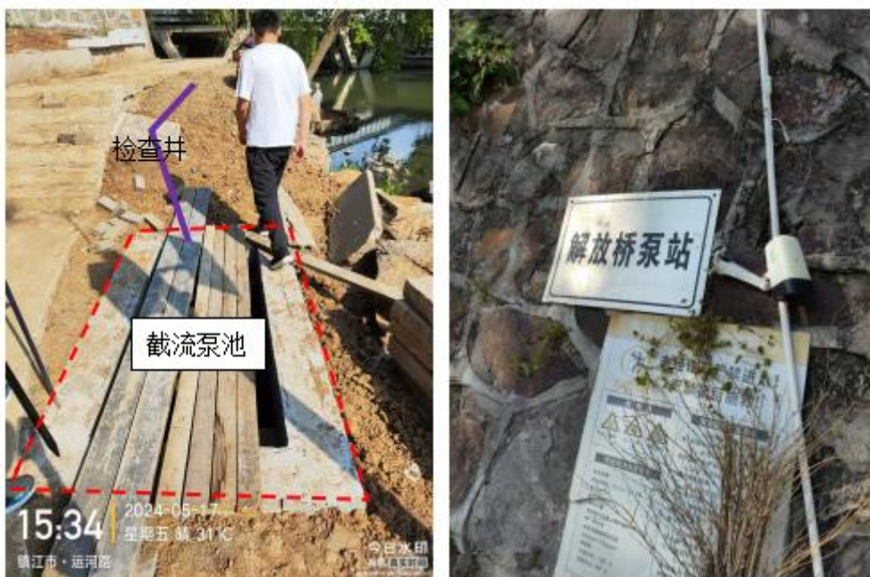
图 3-12 截流泵现状情况图
