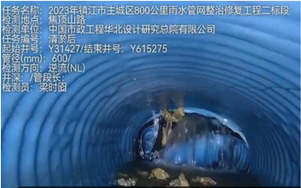
图 3-28 市政雨水主管破裂、变形情况图
