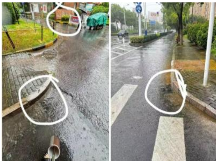
图 3-33 雨天路面积水情况图
