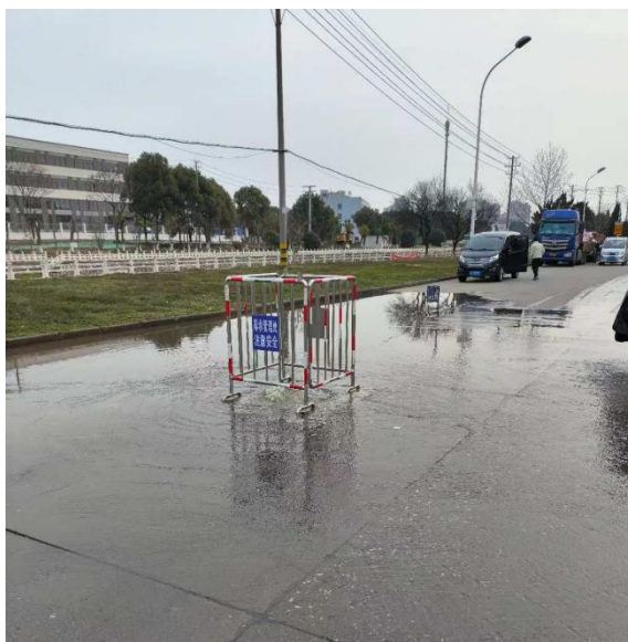
图 3-35 雨天污水检查井漫溢情况图
