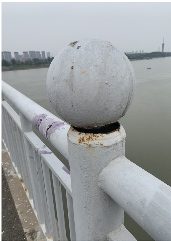
护栏立柱破损
