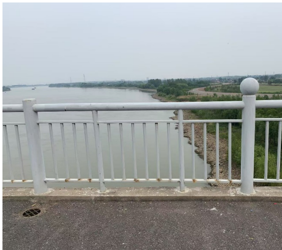
护栏竖杆与横梁连接处锈胀
