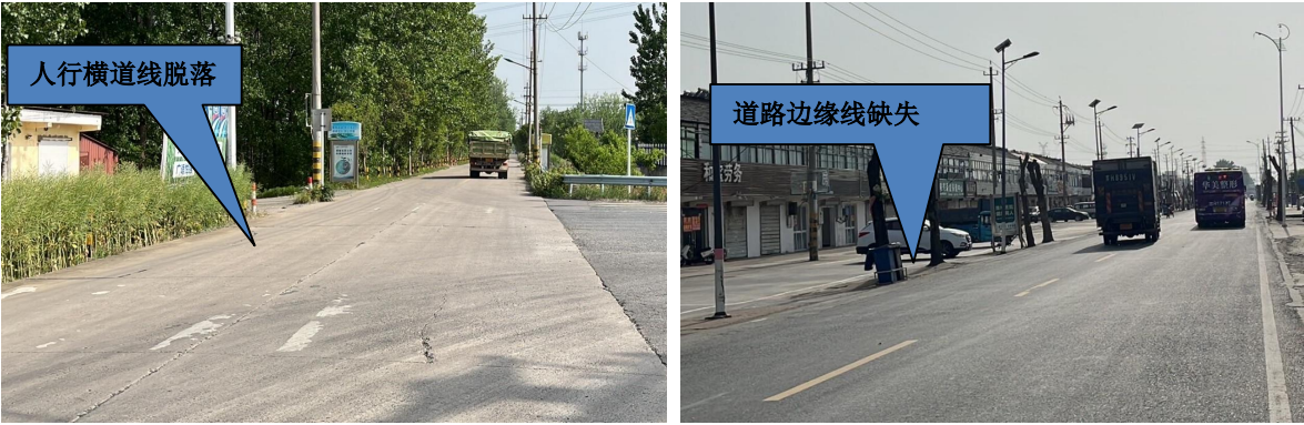
标线磨损严重或未施画相对应标线
