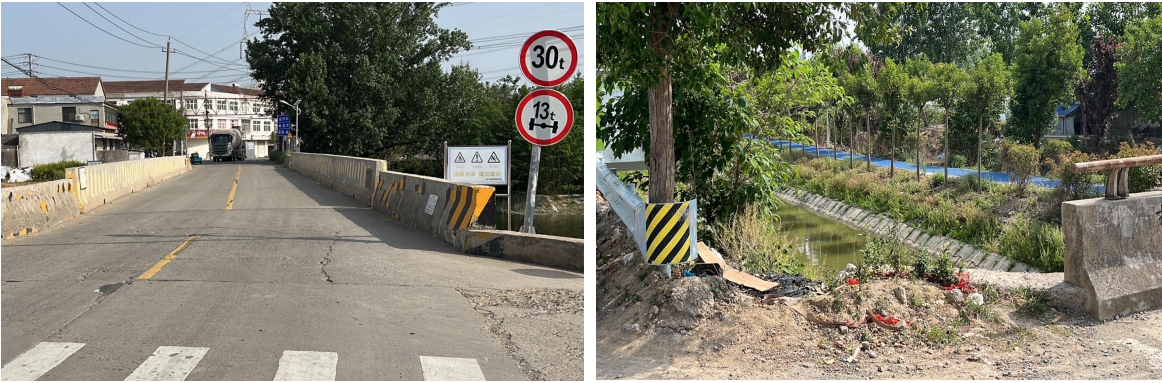
桥梁路段警示不足
