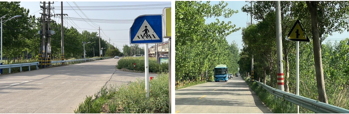
交叉口标志损坏、标线磨损
