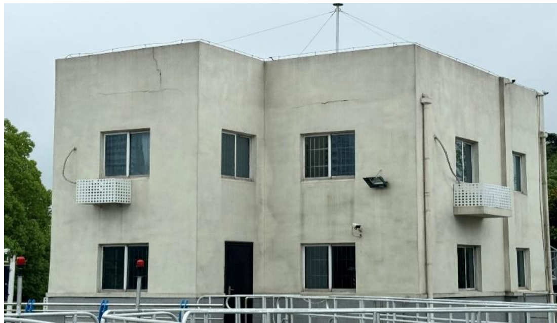
图 4.2-1 启闭机房裂缝图
