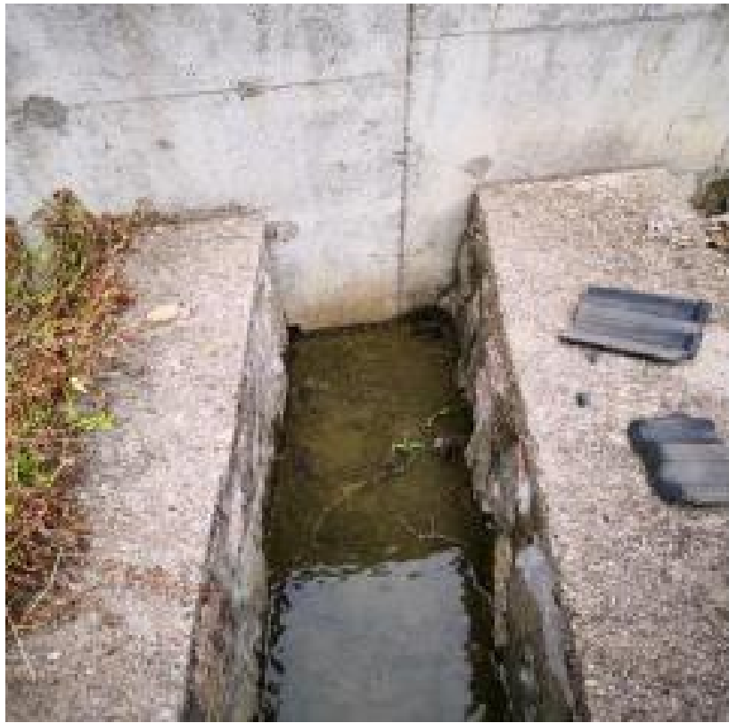
图 4.3-1 低涵两侧局部渗水
