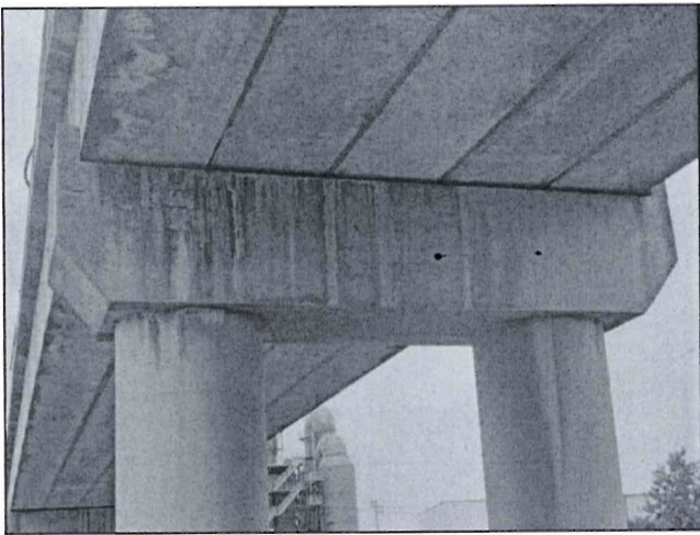
盖梁处渗漏水
