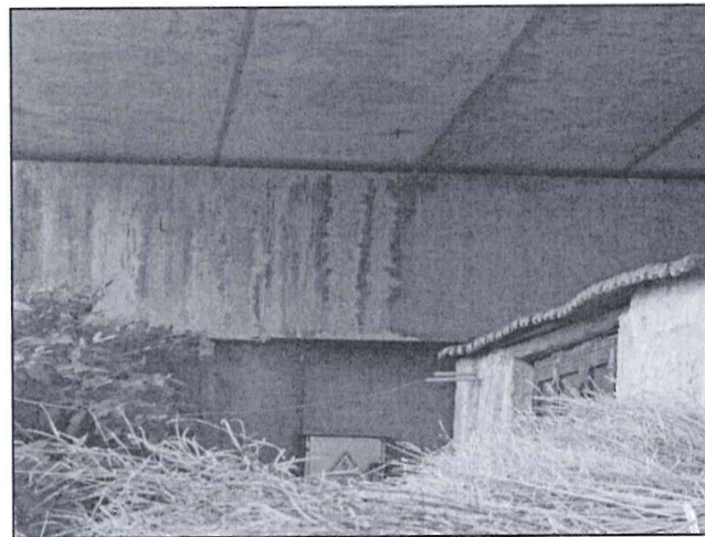
桥台处渗漏水
