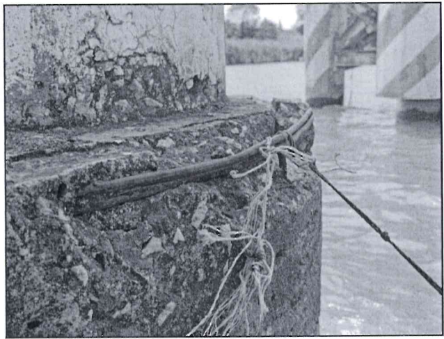
墩柱表面蜂窝麻面
