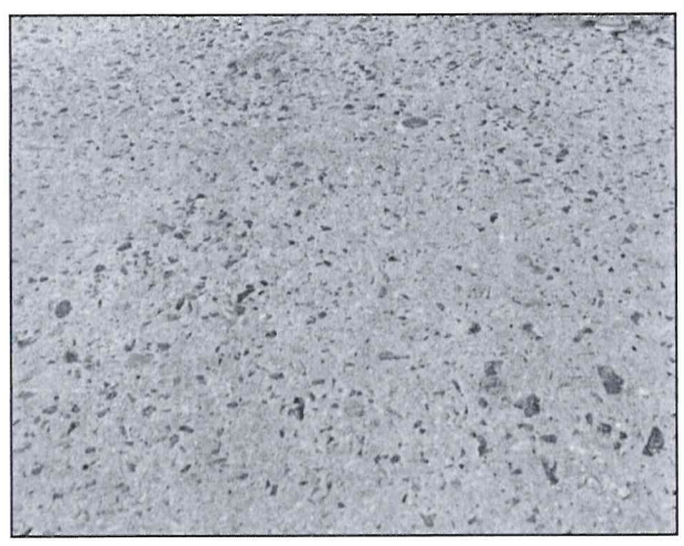
桥面铺装轻微骨料外露
