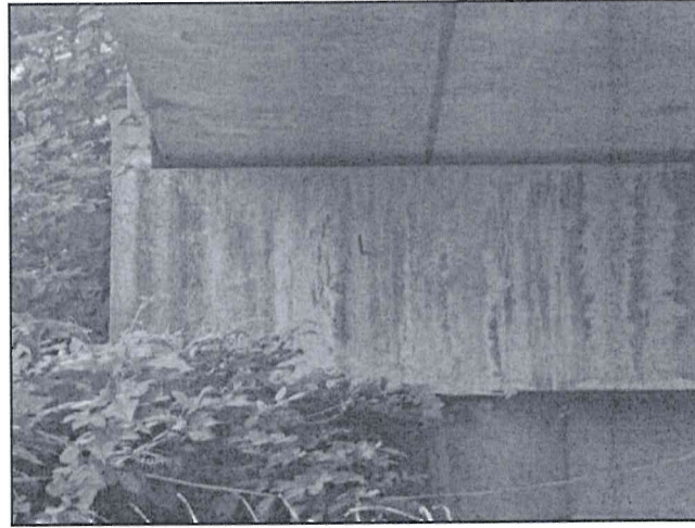
桥台锈胀露筋
