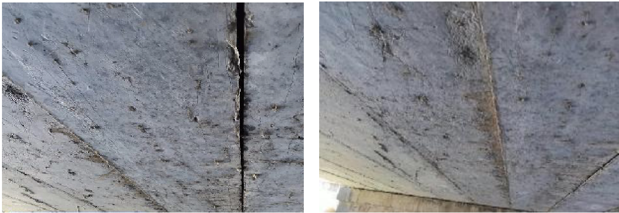
(3) 台帽局部混凝土胀裂，露筋锈蚀；1#桥台左侧墙灰缝脱落。
