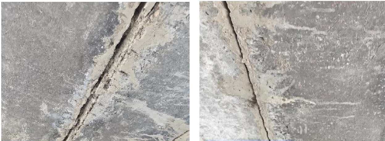
板底局部露筋、铰缝渗水
