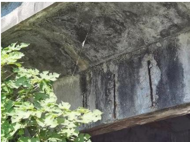
(4) 1-1#次拱腿露筋锈蚀；1-2#次拱腿混凝土胀裂、环向开裂；2-1#次拱腿环向开裂；2-2#次拱腿露筋锈蚀；3-2#次拱腿断裂、混凝土破损，主筋外露锈蚀；3-1#次拱腿露筋锈蚀；4-2#次拱腿露筋锈蚀、竖向裂缝。
