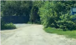
平西路破碎板
