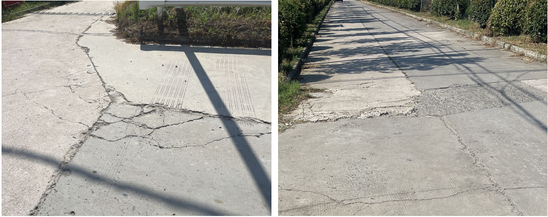
梁江路路面典型病害
