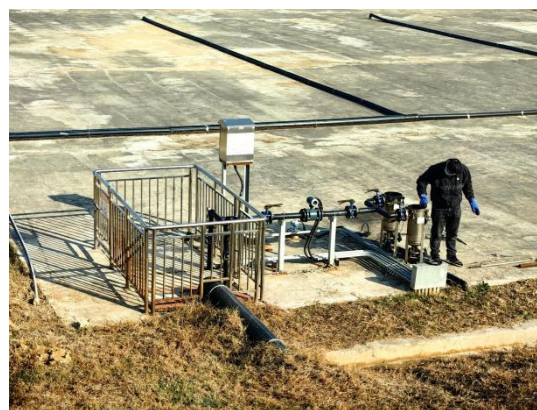
图 d 池顶袋式过滤器
