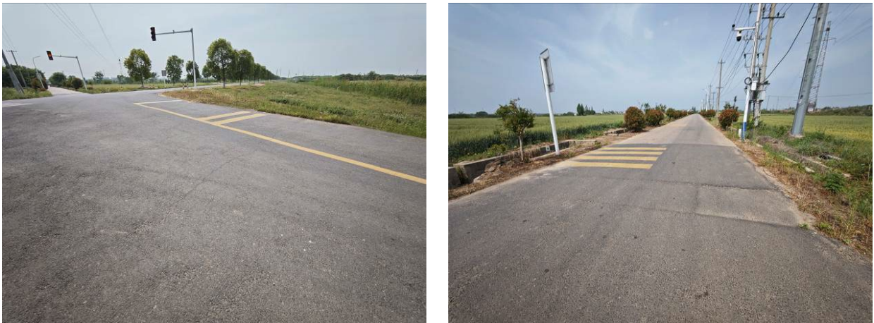
直别公路交叉口沥青路面病害照片
