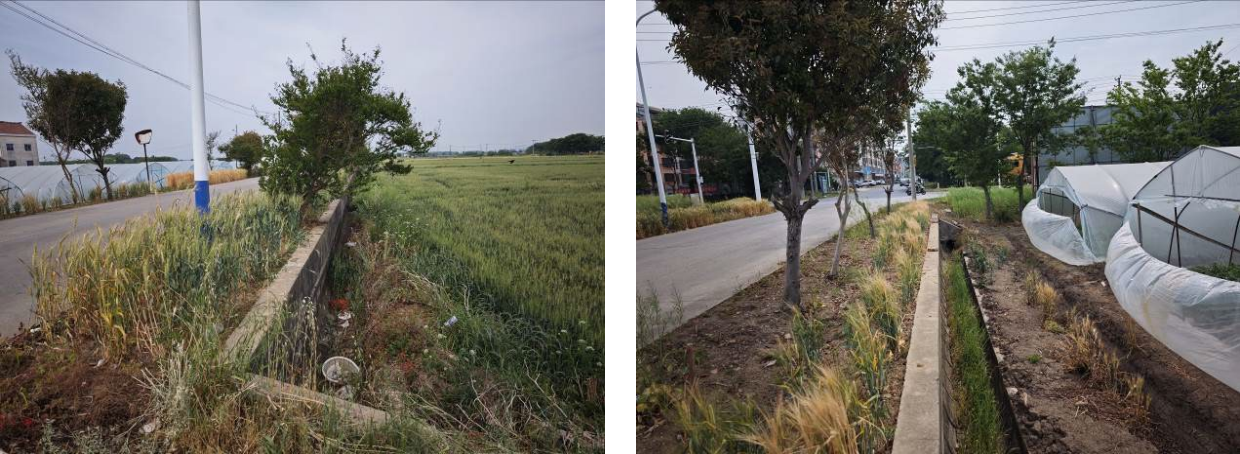
现状排水照片
