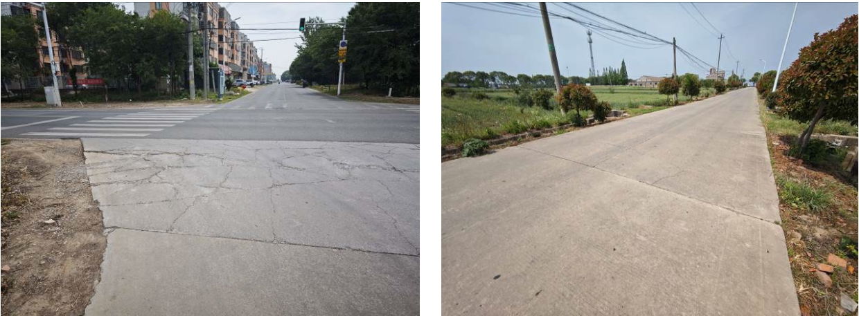
水泥砼路面病害照片
