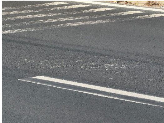
网状裂缝、麻面
