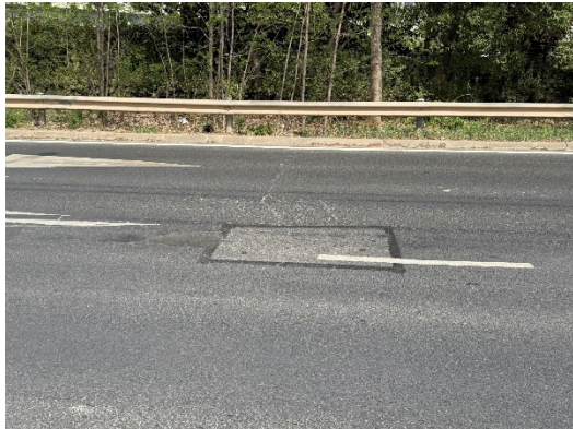
修补、网状裂缝
