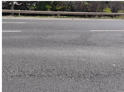
麻面、网状裂缝
