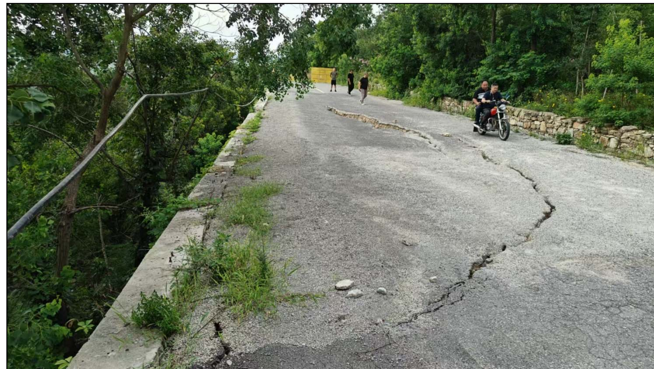
照片 3-1、滑坡后缘道路裂缝
