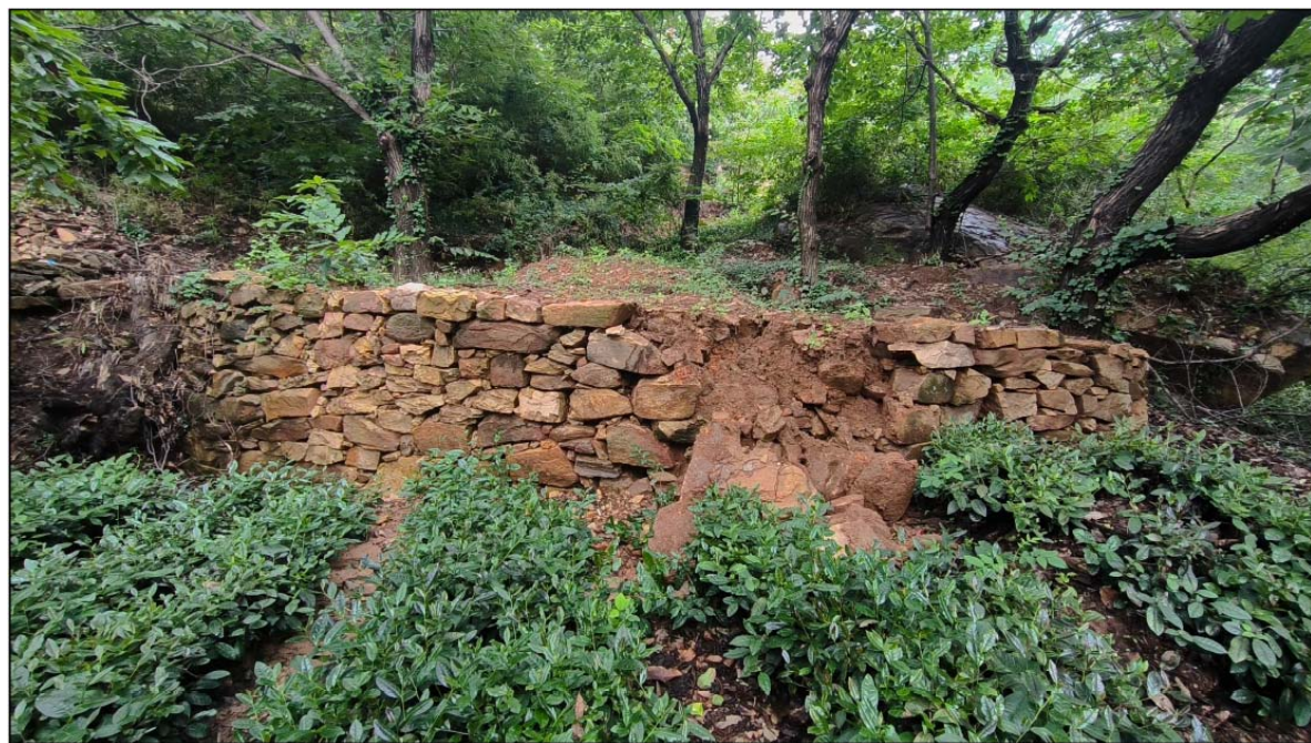
照片 3-4、前缘挡墙开裂坍塌
