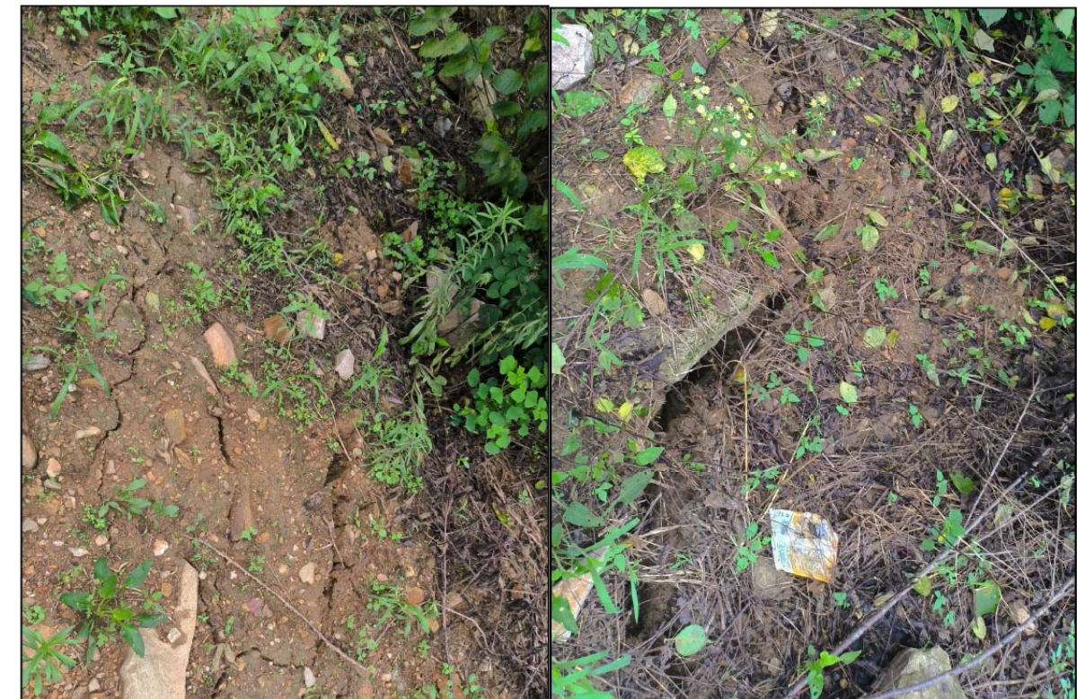
照片 3-3、次级台坎鼓胀裂缝
