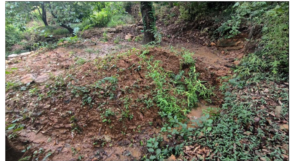
照片 3-2、滑坡体中部渗水点
