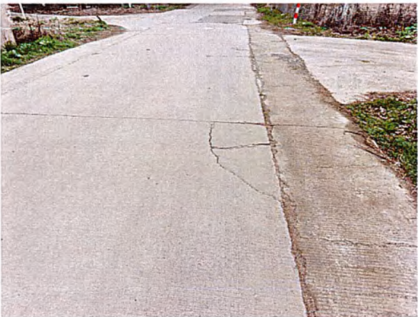
板角断裂病害
