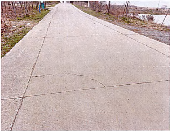
板角断裂病害
