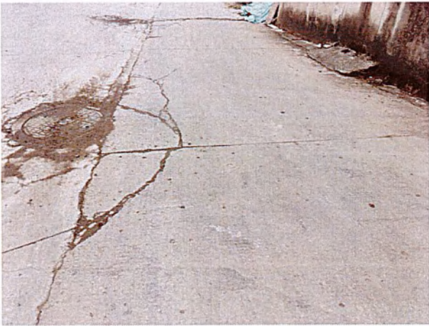
板角断裂病害
