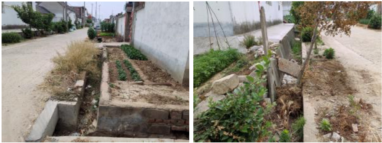
主路设置排水方沟（部分路段损坏严重）
