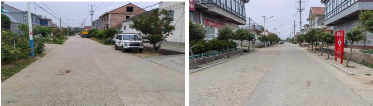
白改黑道路现状照片
