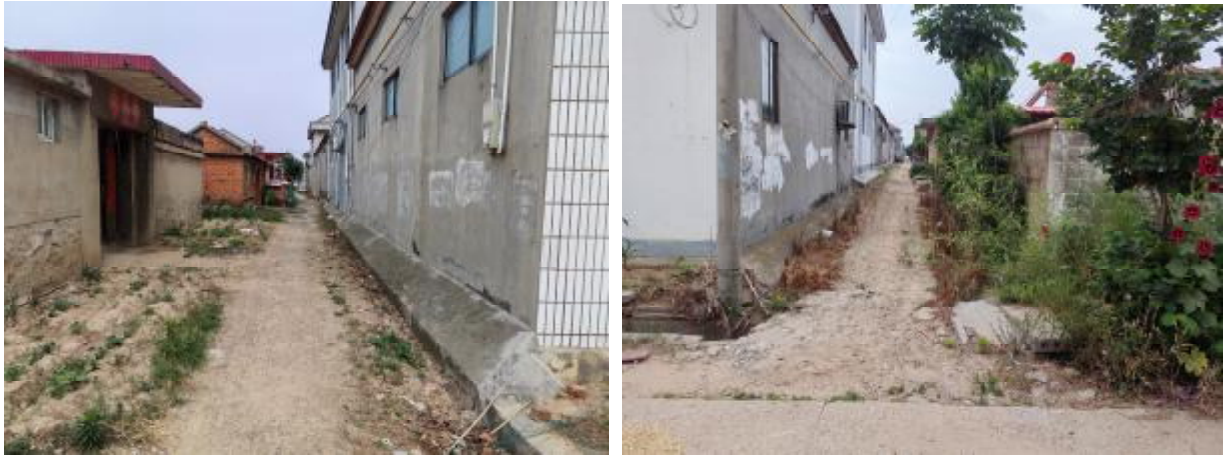
现状巷道缺少排水
