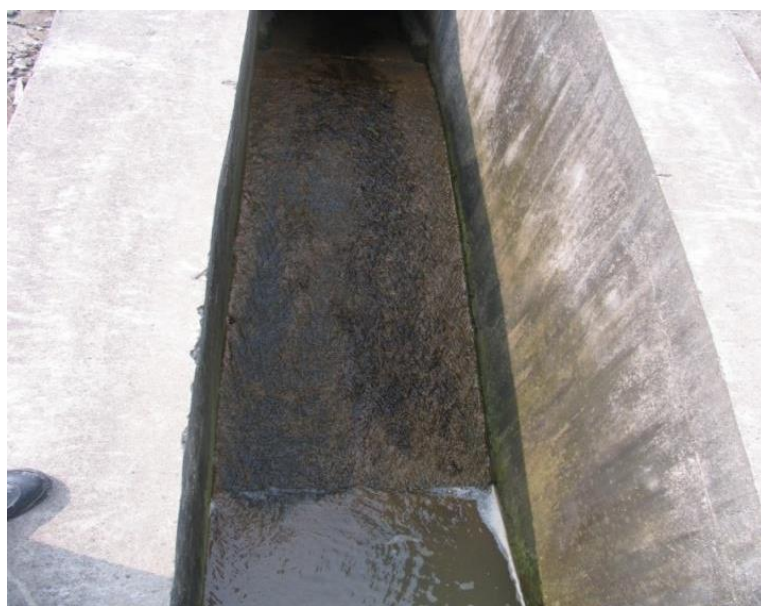
图 4.3-3 涵洞闸门漏水
