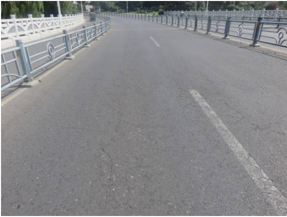
3#孔桥面铺装机动车道龟裂
