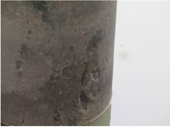
3-4#墩立柱小桩号面破损
