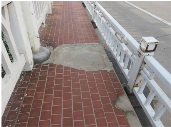
1#孔左侧人行道面板面板缺失
