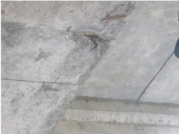
12#孔 1#系杆底面 8#、9#横梁间胀裂
