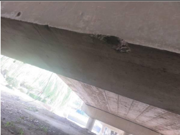
7#墩 1#盖梁底面破损
