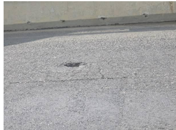
13#孔桥面铺装左侧非机动车道坑槽
