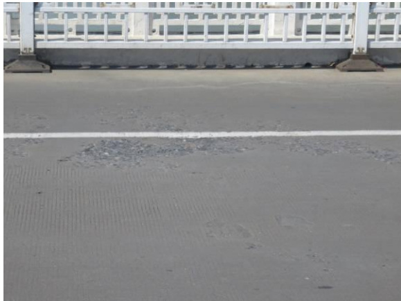
6#孔桥面铺装机动车道砼剥落骨料外露
