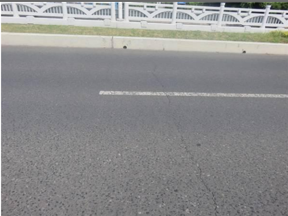
9#孔桥面铺装机动车道横向裂缝
