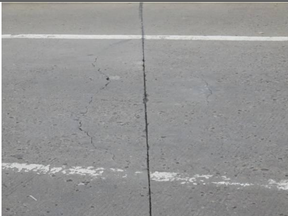
2#孔桥面铺装右侧机动车道横向裂缝
