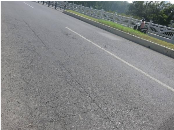
9#孔桥面铺装机动车道龟裂
