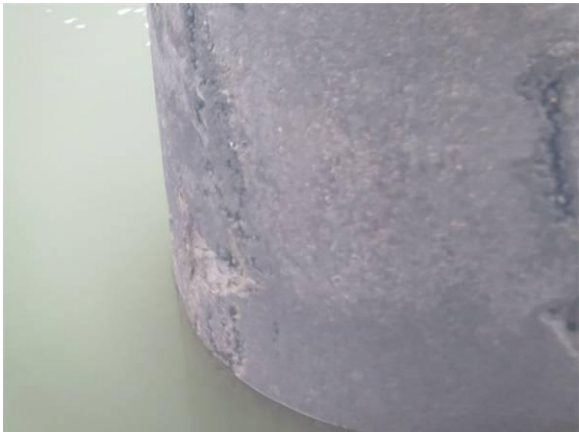
5-3#墩立柱小桩号面破损
