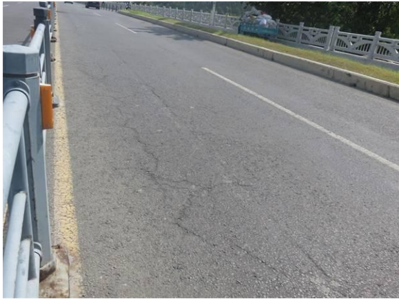
11#孔桥面铺装机动车道网裂
