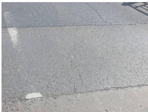
图 4-1 0#台桥路连接纵向裂缝
