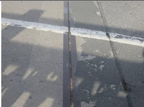
1#伸缩装置堵塞
