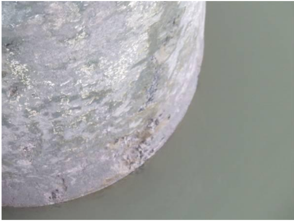
4-2#墩立柱小桩号面破损
