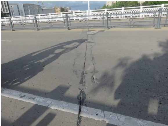
2#孔桥面铺装机动车道横向裂缝
