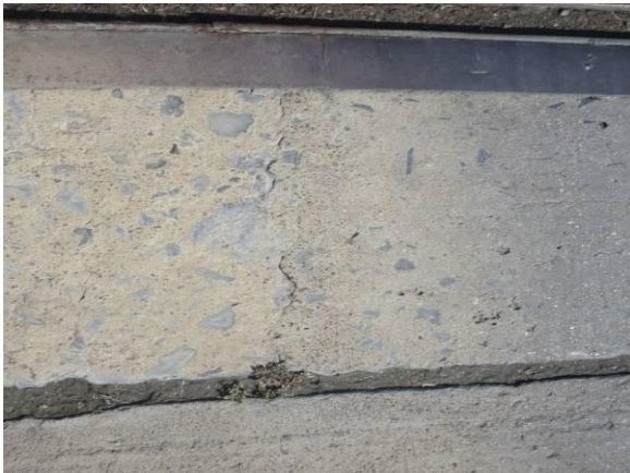
2#伸缩装置机动车道锚固砼纵桥向开裂
