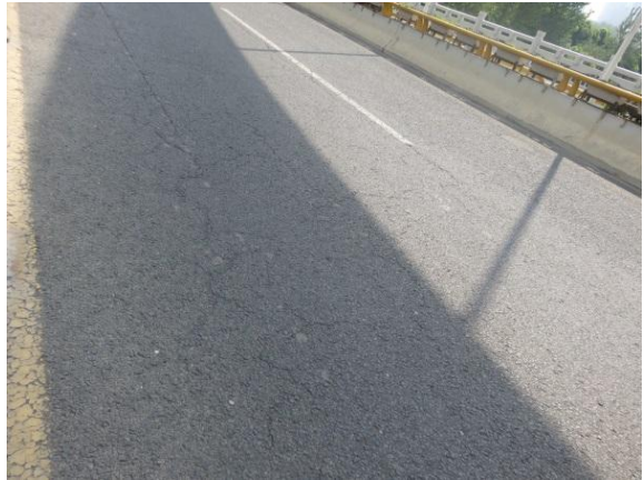
12#孔桥面铺装机动车道龟裂
