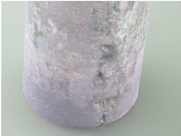
5-2#墩立柱小桩号面破损
