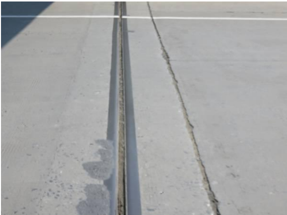
2#伸缩装置机动车道堵塞
