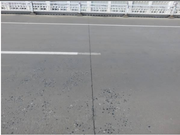
6#孔桥面铺装机动车道横向裂缝
