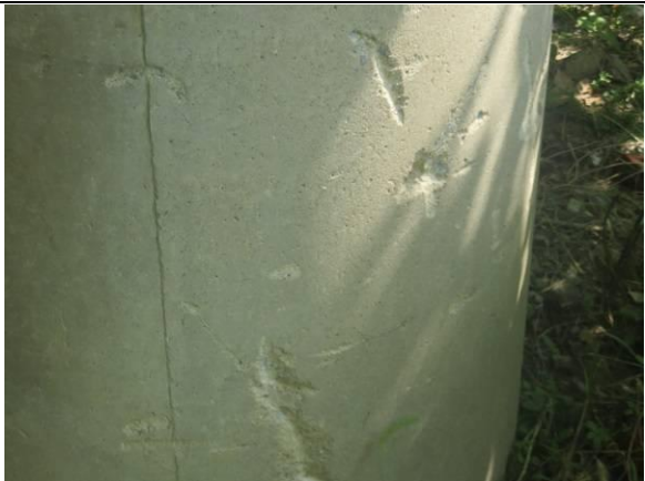
8-1#墩立柱大桩号面破损
