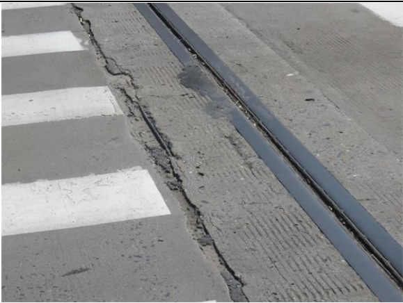
1#伸缩装置机动车道锚固砼破损，锚固区露筋
