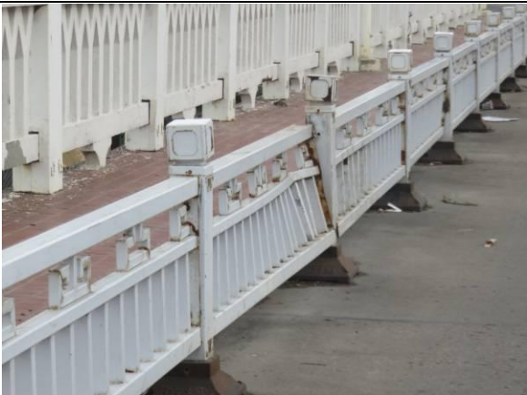
2#孔右侧分隔栏杆杆件，变形
