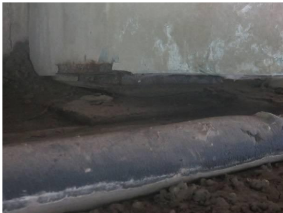
13-13#支座（板）支座钢垫板锈蚀
