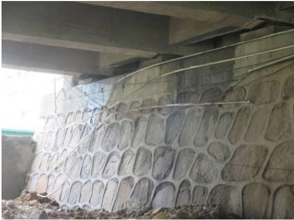
3#台台帽渗水侵蚀
