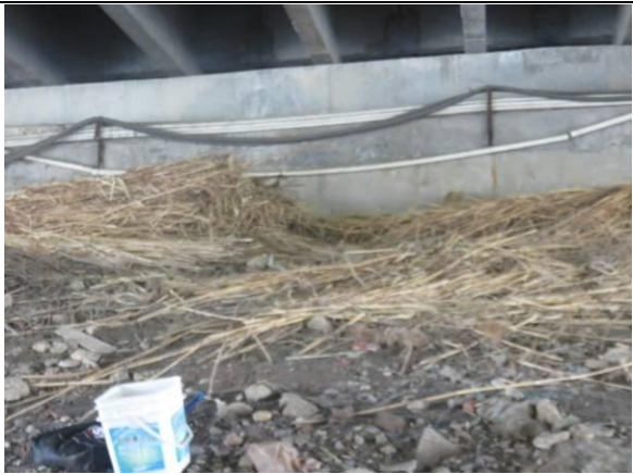
1#孔桥下空间，易燃物堆积
