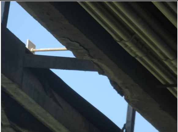
6-1#梁底板露筋，破损
