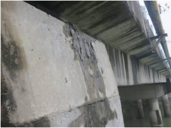
5#墩 1#盖梁左侧面锈胀
