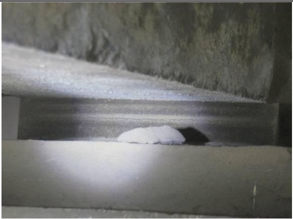
4-5X 支座（板）老化开裂
