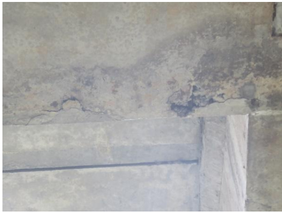
12#孔 1#系杆 10、11#横梁间破损露筋
