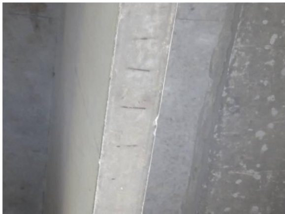
10-10#梁底板露筋锈蚀
