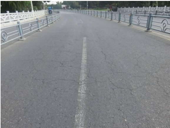
2#孔桥面铺装机动车道龟裂
