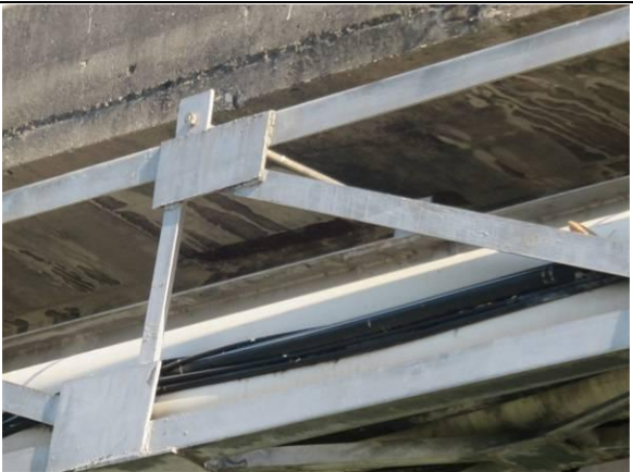
6-18#T 梁胀裂露筋锈蚀
