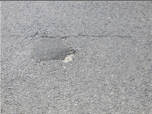
4#孔桥面铺装左侧机动车道坑槽
