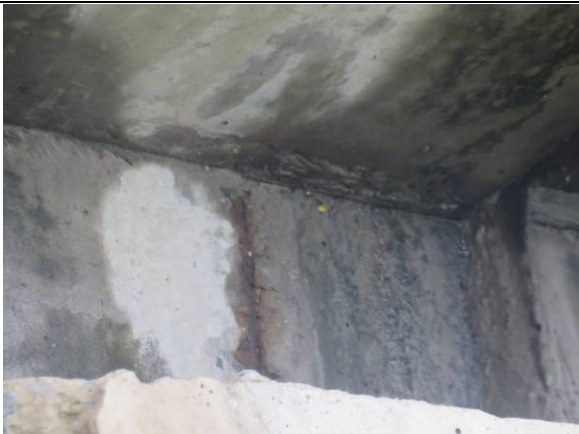
5-1#梁左腹板露筋
