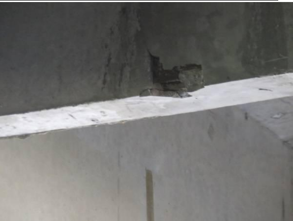
10-6-3#跨间横隔板小桩号面破损
