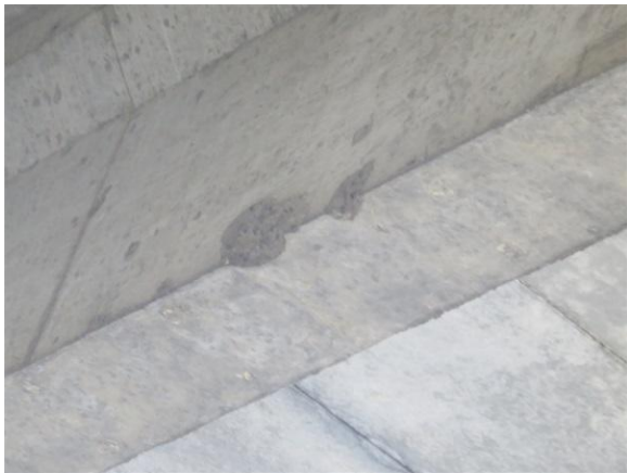
主桥 12#孔 11#横梁 16#、17#板梁处破损
