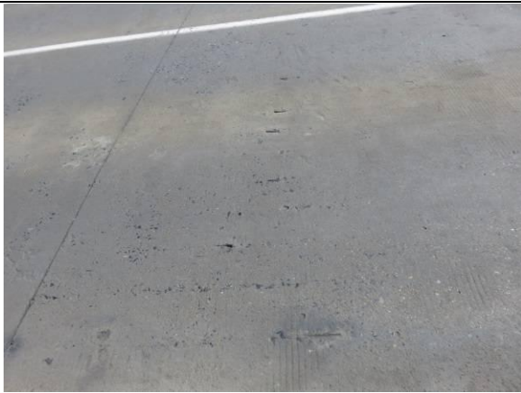
5#孔桥面铺装机动车道露筋锈蚀
