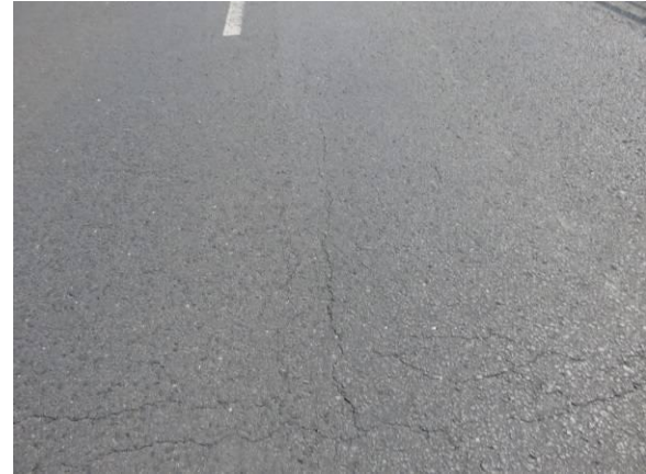
13#孔桥面铺装机动车道纵向裂缝
