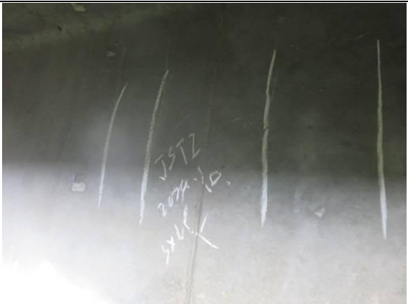
2-15#梁左腹板竖向裂缝，4#5#横隔板间
