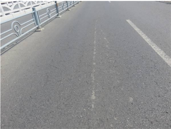
5#孔桥面铺装机动车道龟裂
