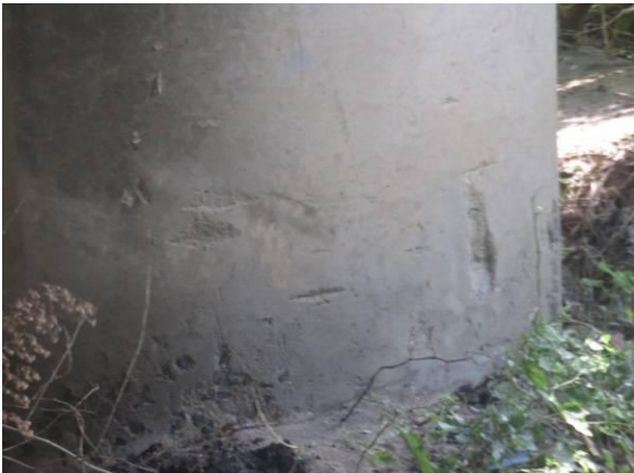
7-1#墩立柱大桩号面破损
