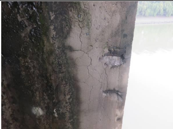
5#墩 1#盖梁大桩号面露筋
