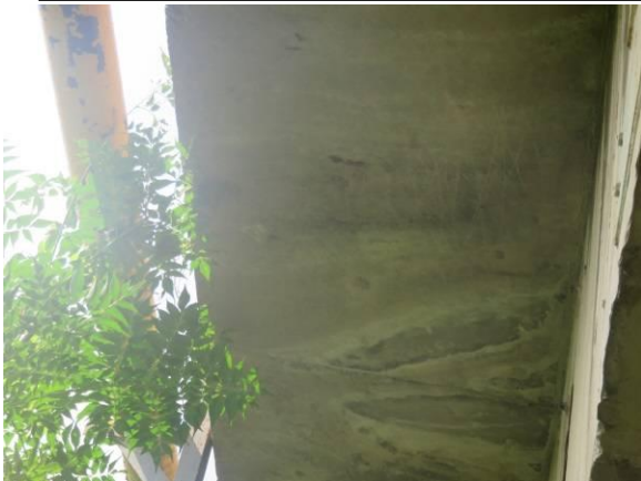
8-1#梁左翼板露筋锈蚀
