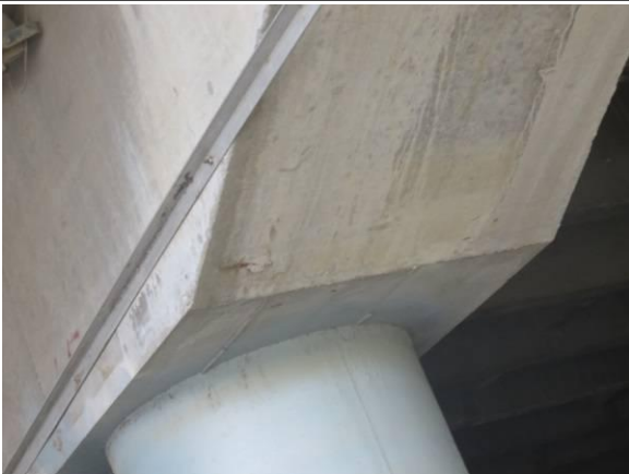
1#墩盖梁底面锈胀，露筋锈蚀，左侧悬臂
