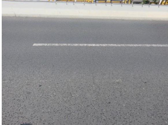
12#孔桥面铺装机动车道横向开裂
