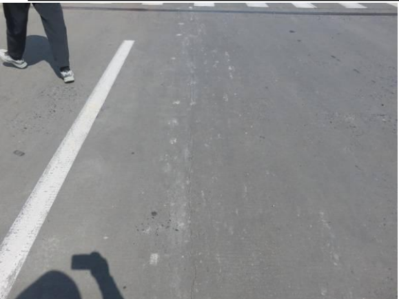
1#孔桥面铺装机动车道纵向裂缝
