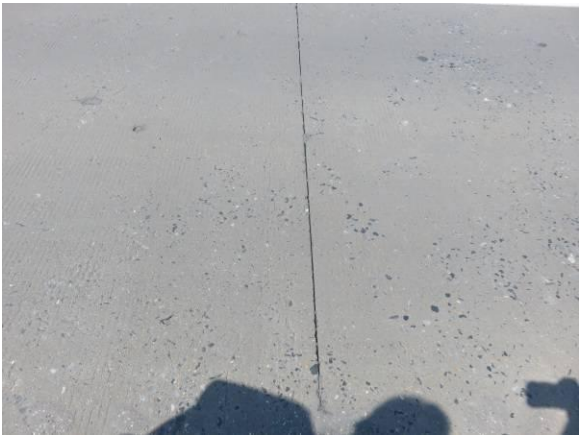
图 3.1-75#孔桥面铺装机动车道横向裂缝
