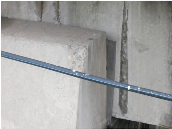
3#墩 1#盖梁右侧挡块挡块破损
