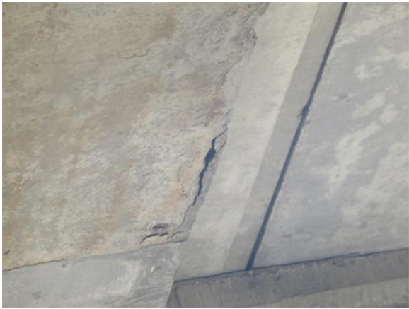
主桥 12#孔 4#横梁,小桩号面距右边缘 5.0m 胀裂露筋锈蚀
