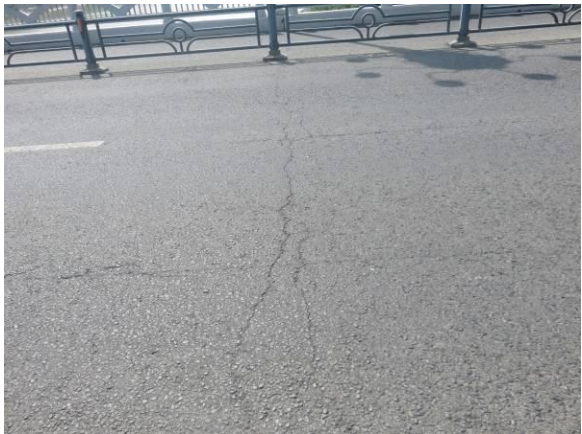
6#孔桥面铺装机动车道横向裂缝
