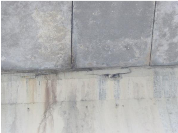
12#孔 13#横梁小桩号面，距左边缘 9.0m 破损露筋
