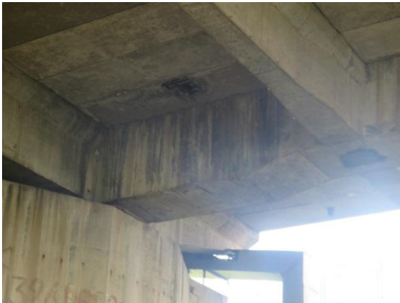
主桥 12#孔右侧系杆渗水痕迹
