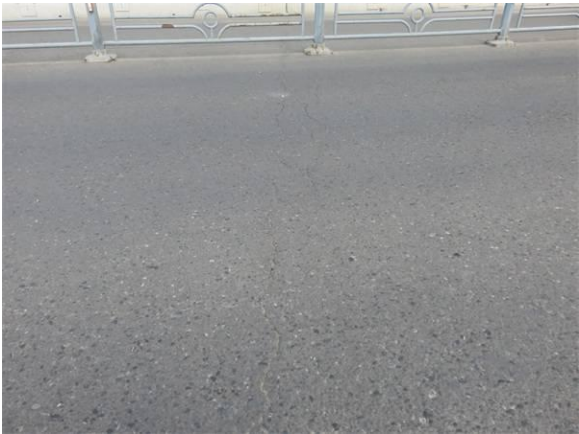
1#孔桥面铺装机动车道横向裂缝
