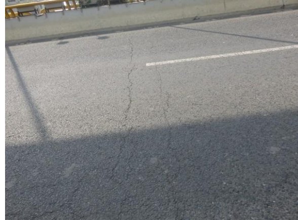
12#孔桥面铺装机动车道横向开裂
