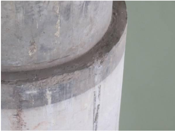
2-3#墩立柱小桩号面船撞破损
