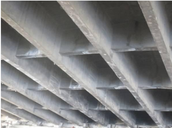
1-11#梁底板火烧熏黑
