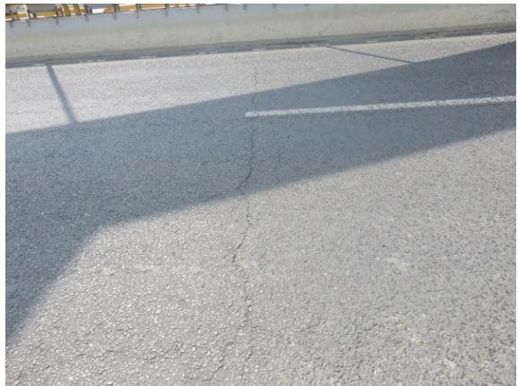
12#孔桥面铺装机动车道横向开裂
