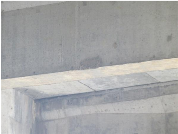
主桥 12#孔 8#横梁 16#、17#板梁处破损
