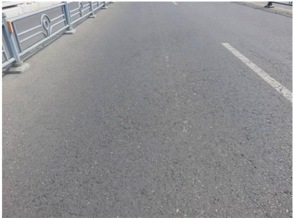
4#孔桥面铺装机动车道龟裂
