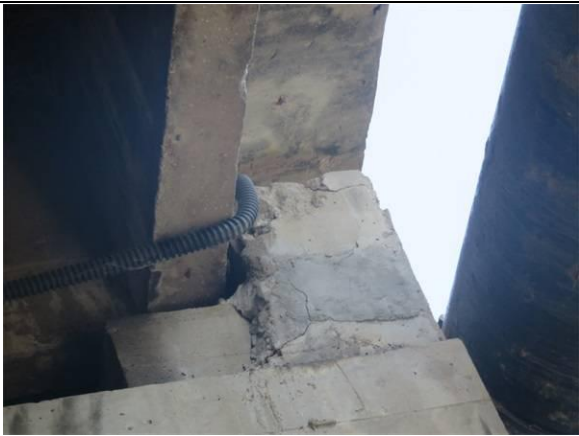
6#墩盖梁左侧挡块破损，大桩号面
