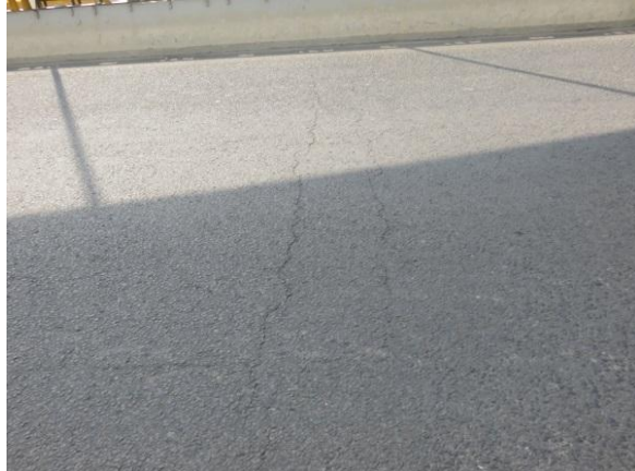
12#孔桥面铺装机动车道横向开裂
