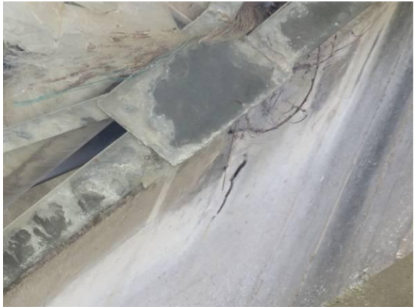
3-18#右腹板纵向裂缝
