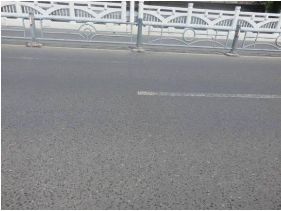
3#孔桥面铺装机动车道横向裂缝
