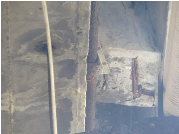
全桥挑梁露筋锈蚀
