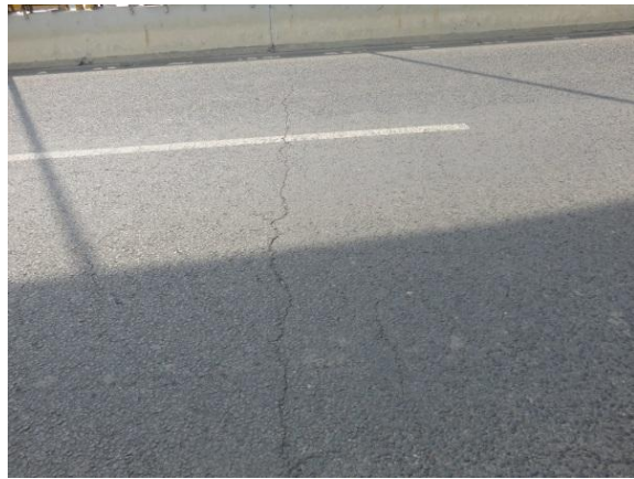
12#孔桥面铺装机动车道横向开裂
