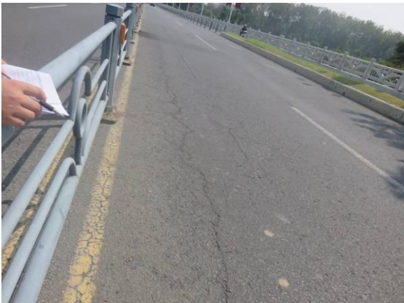
10#孔桥面铺装机动车道纵向裂缝
