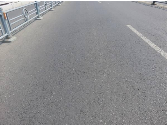
7#孔桥面铺装机动车道龟裂
