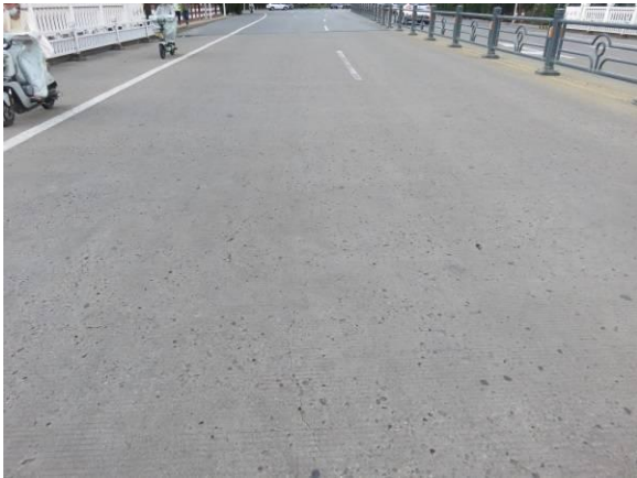
3#孔桥面铺装右侧机动车道纵向裂缝
