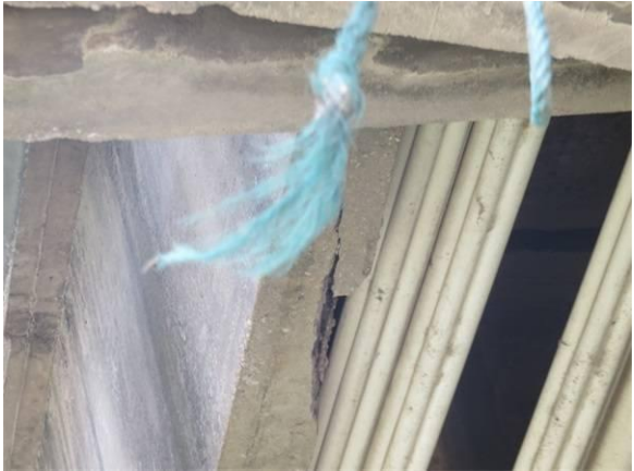
2-18#T 梁露筋，破损
