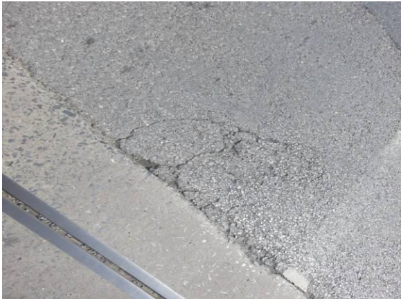
图 4-4 0#台桥路连接引道沉降
