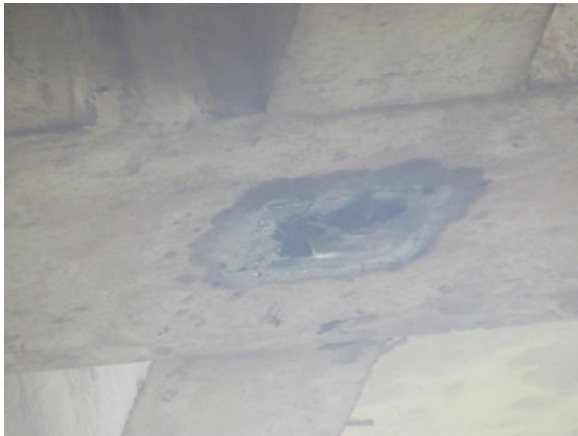
主桥 12#孔 2#系杆底面 1#~7、9#、11#吊杆封锚渗油
