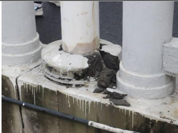
左侧照明设施损坏，路灯基座破损
