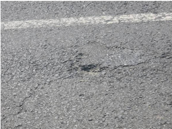
9#孔桥面铺装机动车道坑槽
