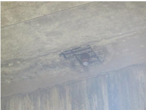
桥面板破损露筋
