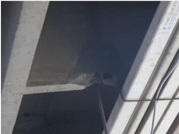
4-2-3#跨间横隔板破损
