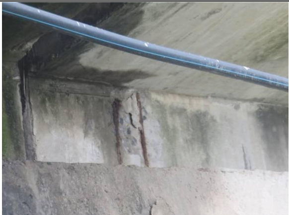
4-1#梁左腹板露筋
