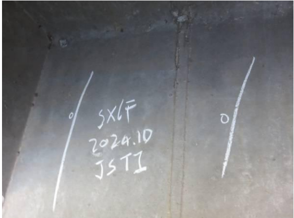
2-15#右腹板竖向裂缝，4#5#横隔板间
