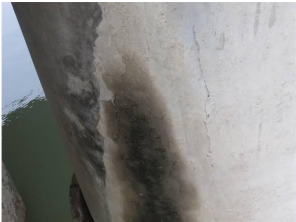
5-4#墩立柱大桩号面锈胀
