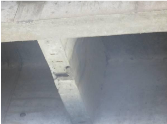
6-4-4#跨间横隔板锈胀，露筋锈蚀
