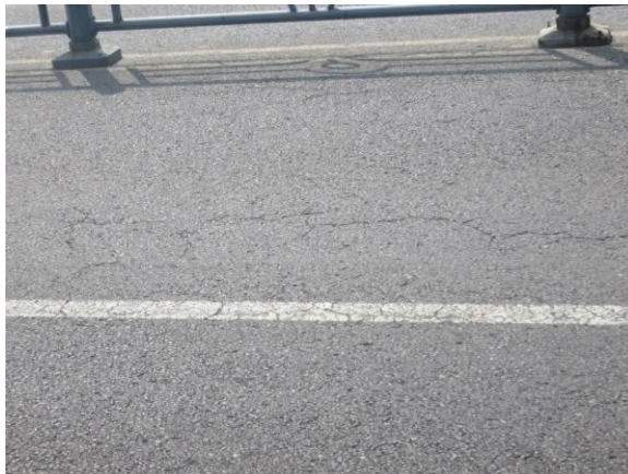
3#孔桥面铺装机动车道网裂
