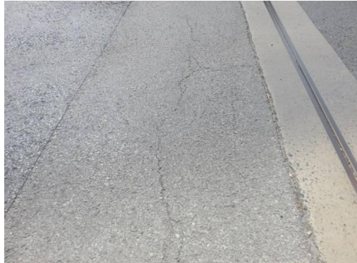
图 4-2 0#台桥路连接横向裂缝
