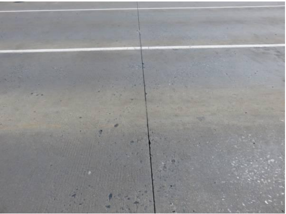
图 5.1.2-12#孔桥面铺装机动车道横向裂缝
