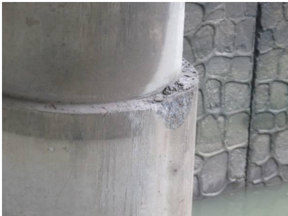
5-4#墩立柱小桩号面破损
