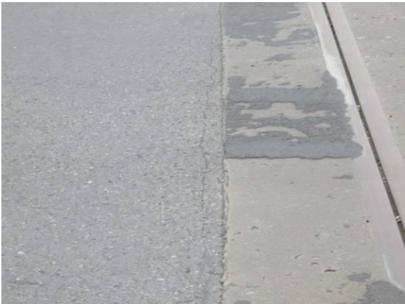
3#孔桥面铺装机动车道横向裂缝
