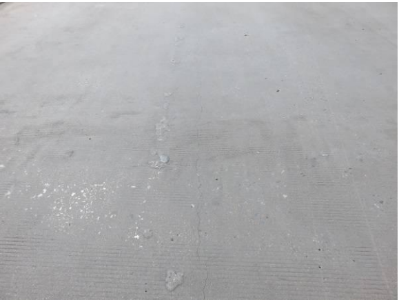
图 3.1-64#孔桥面铺装机动车道纵向裂缝
