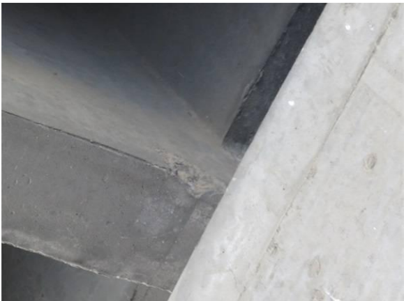
图 3.2-62-10#梁左腹板破损
