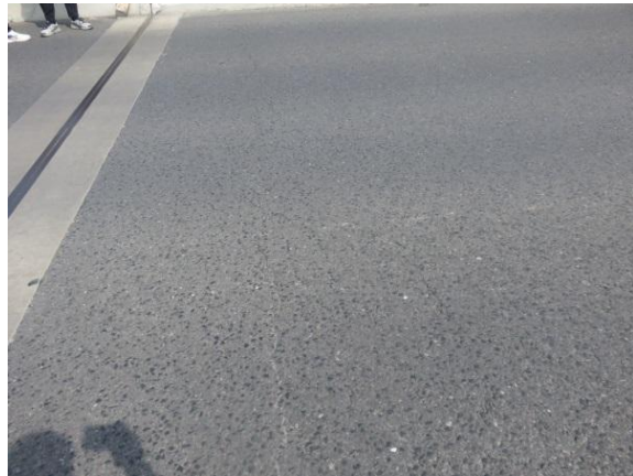
12#孔桥面铺装机动车道横向开裂
