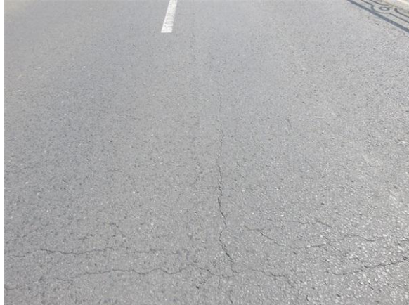
12#孔桥面铺装机动车道纵向开裂
