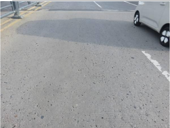
1#孔桥面铺装左侧机动车道纵向裂缝
