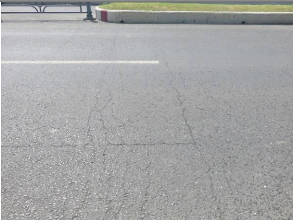
8#孔桥面铺装机动车道横向裂缝
