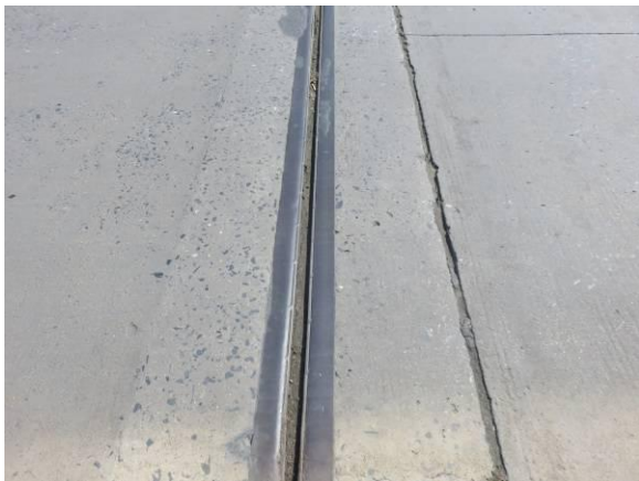
2#伸缩装置机动车道锚固砼骨料外露
