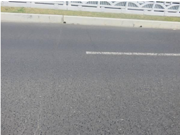
10#孔桥面铺装机动车道横向裂缝
