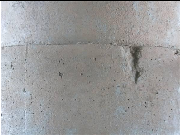
5-3#墩立柱大桩号面破损
