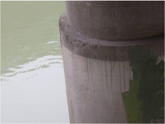
图 3.5-52-4#墩立柱小桩号面船撞破损
