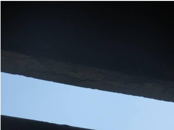
2-1#梁底板锈胀, 近跨中处
