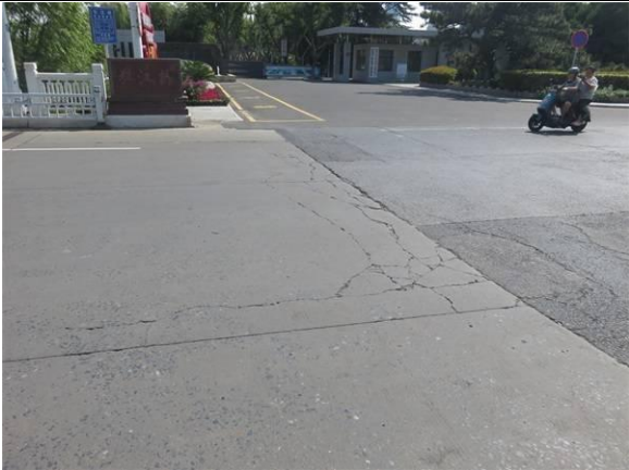
图 3.1-17#台桥路连接机动车道网裂
