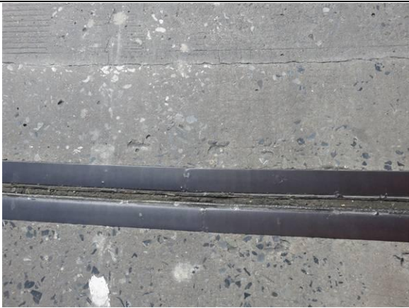
图 5.1.3-11#伸缩装置机动车道锚固砼横桥向开裂
