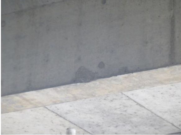
主桥 12#孔 9#横梁 16#、17#板梁处破损
