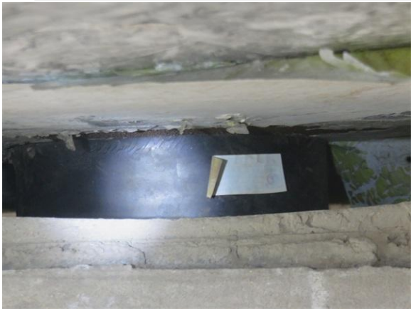
6-34X 支座（板）老化开裂
