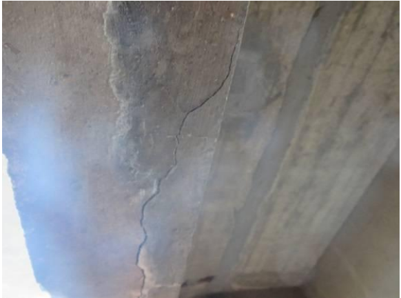
7-8#梁左腹板锈胀
