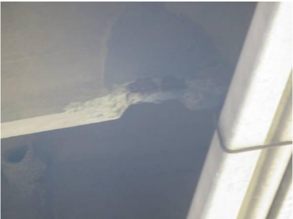
4-2-4#跨间横隔板破损
