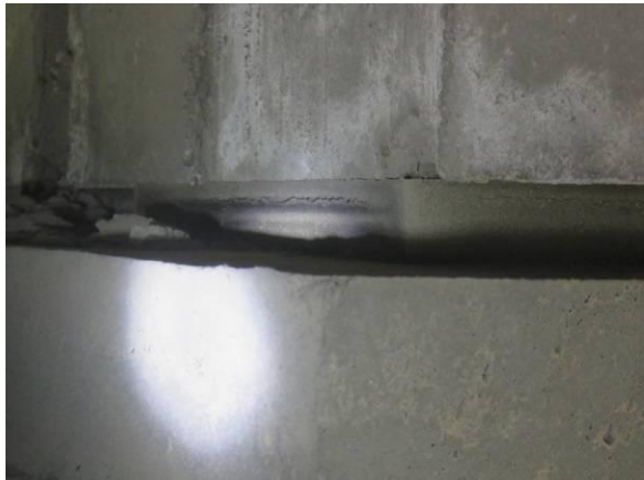
5-13X 支座（板）老化开裂
