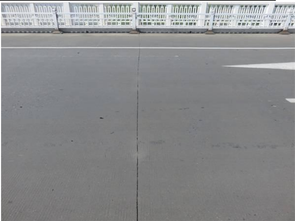
1#孔桥面铺装机动车道横向裂缝
