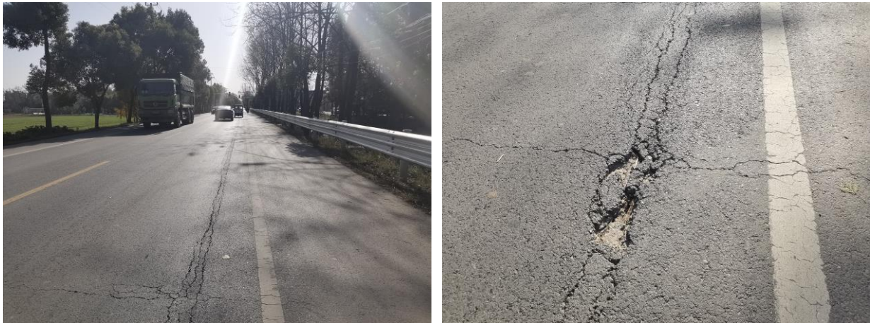
图 2-8 K0+830-K1+280 段原板块分缝处带状龟裂病害
