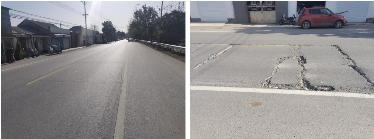
图 2-7 K0+000-K0+830 段局部路段破碎板
