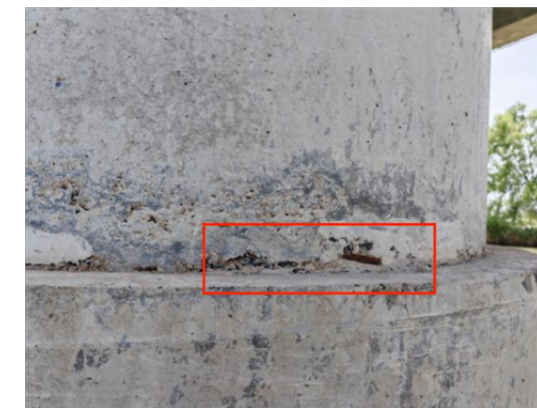
74-1#墩露骨料、露筋
