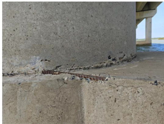
59#系梁锈胀露筋
