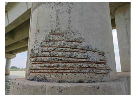
66-2#墩锈胀露筋图
