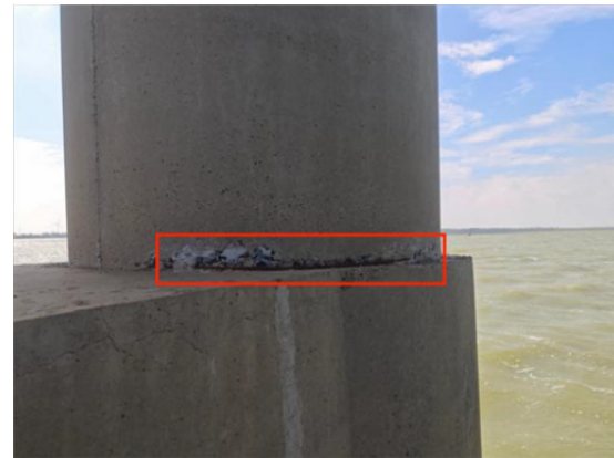
44-2#墩露骨料、露筋
