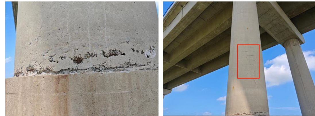
48-2#墩露骨料、露筋
