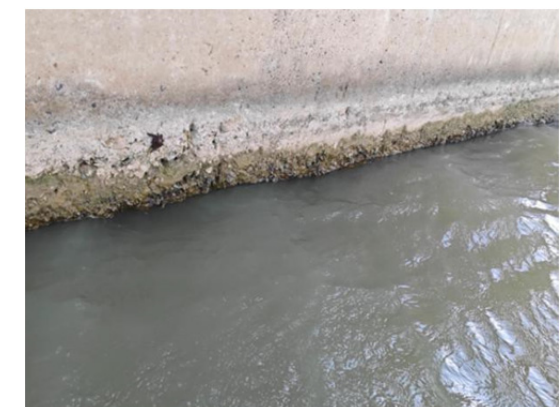
59#系梁露骨料、露筋
