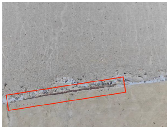
46-2#墩露骨料、露筋
