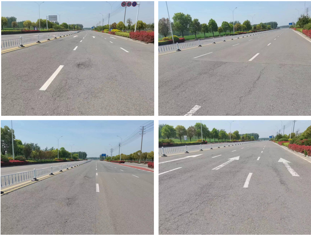
机场中路病害
