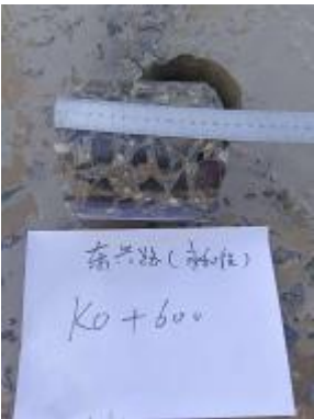
2#砼板块，混凝土面层厚度 15.5cm，基层松散未取出。
