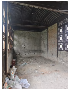
西次间、西梢间檐柱根部中度腐朽；
