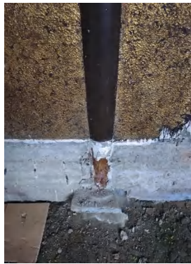
西次间、西梢间檐柱根部中度腐朽；
