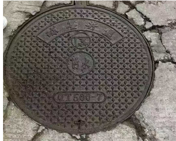
现状井盖随新铺设沥青面层抬高
