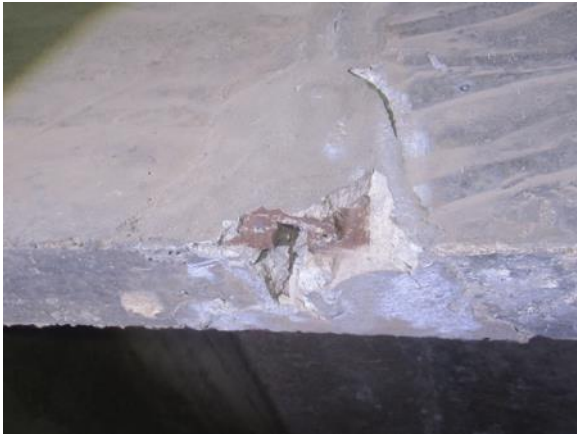
图 2-15 南幅 5-3-8#横隔板破损、钢板外露
