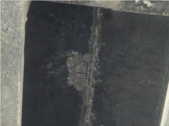
图 2-14 南幅 7-7#T 梁右侧翼缘析白、锈胀露筋
