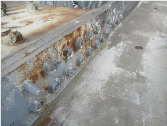
图 2-12 北幅 2#主桁架与 1#上平联螺栓缺失
