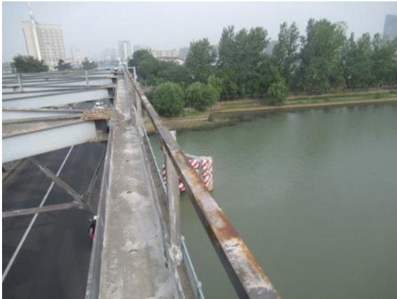
图 2-11 北幅 2#主桁架上弦杆锈蚀
