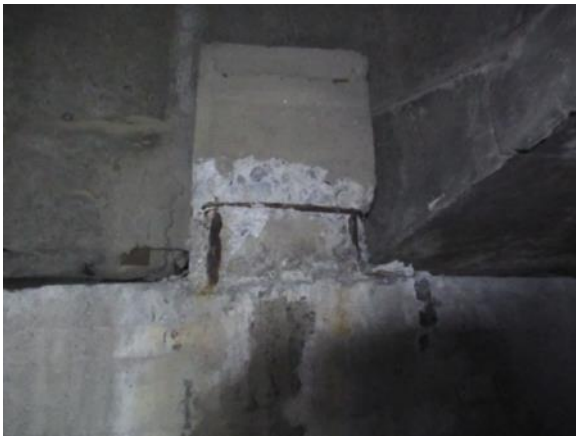
图 2-17 南幅 2#墩 2-1#T 梁右侧挡块锈胀露筋
