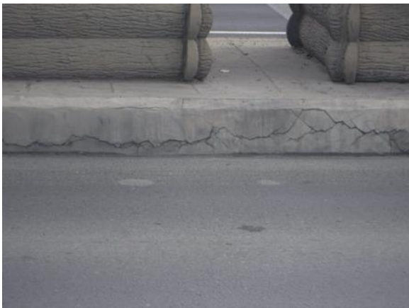
图 2-7 南幅 2#孔中央分隔带路缘石左侧面纵向开裂
