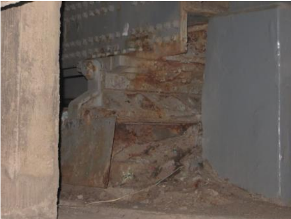
图 2-16 北幅 4-3-2#钢支座锈蚀严重
