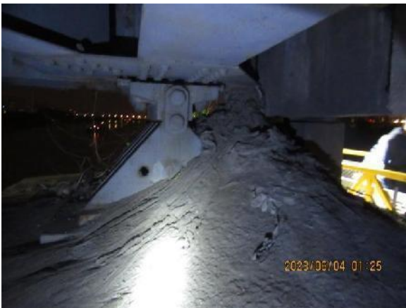
图 2-19 南幅 4#墩盖梁垃圾堆积
