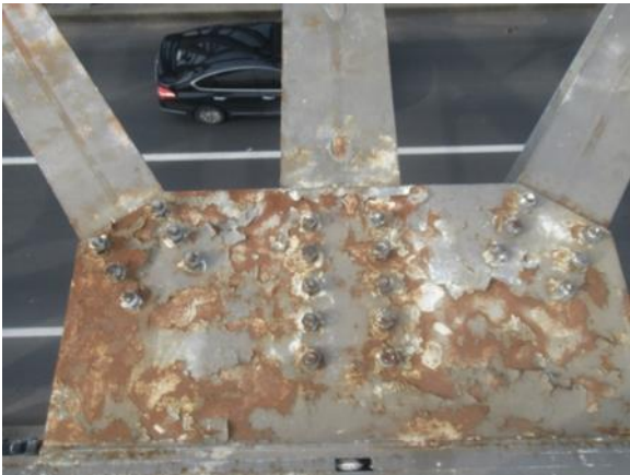
图 2-10 北幅 2#主桁架与 2#上平联锈蚀
