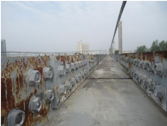
图 2-9 南幅 2#主桁架上弦螺栓锈蚀
