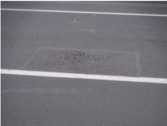
图 2-2 北幅机动车道铺装龟裂坑槽
