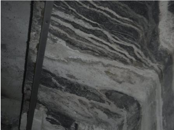
图 2-13 南幅 1-8#T 梁右侧翼板斜向析白
