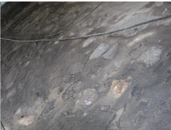
图 2-20 南幅 0#台护坡开裂
