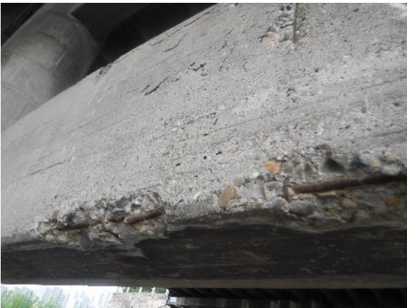
图 2-18 北幅 6#墩系梁东侧面锈胀露筋
