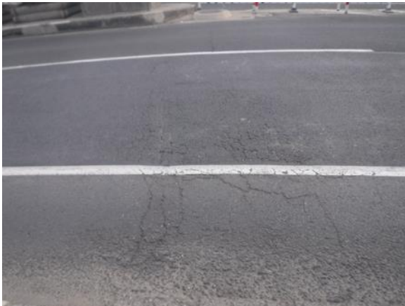
图 2-1 南幅距 1#伸缩缝 8m 机动车道网裂塌陷
