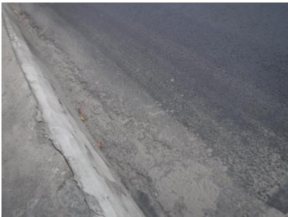
图 2-3 北幅机动车道铺装拥包
