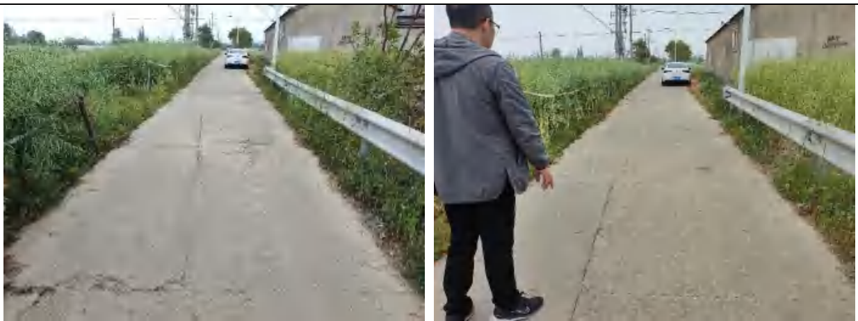
行车道破碎板起点（左）、终点（右） K1+365 处板角断裂病害分布图：
