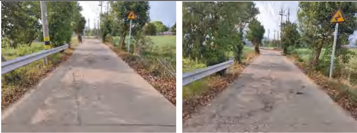
行车道破碎板起点（左）、终点（右） K0+740 处破碎板病害分布图：
