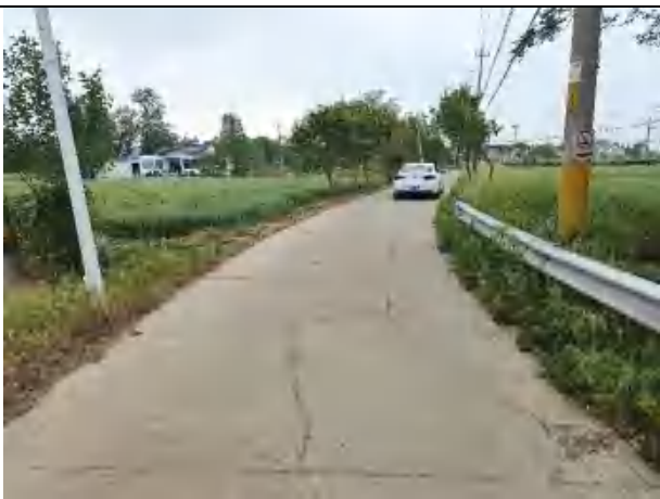
行车道破碎板 K1+100 处破碎板病害分布图：
