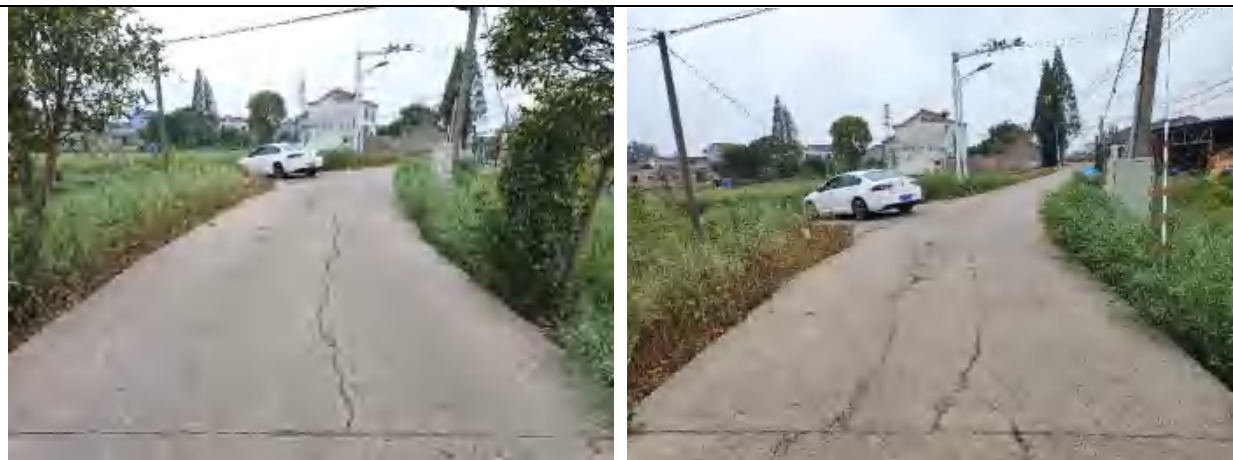
行车道破碎板起点（左）、终点（右） K4+475 处破碎板病害分布图：
