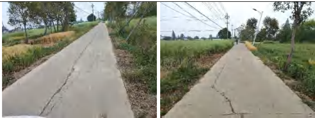
行车道破碎板起点（左）、终点（右） K1+285 处破碎板病害分布图：
