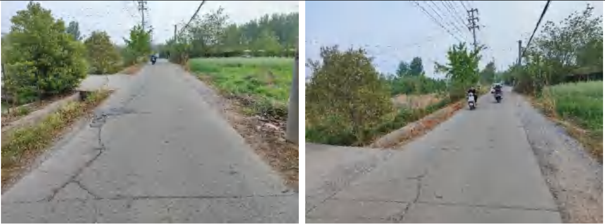
行车道破碎板起点（左）、终点（右） K0+645 处破碎板病害分布图：
