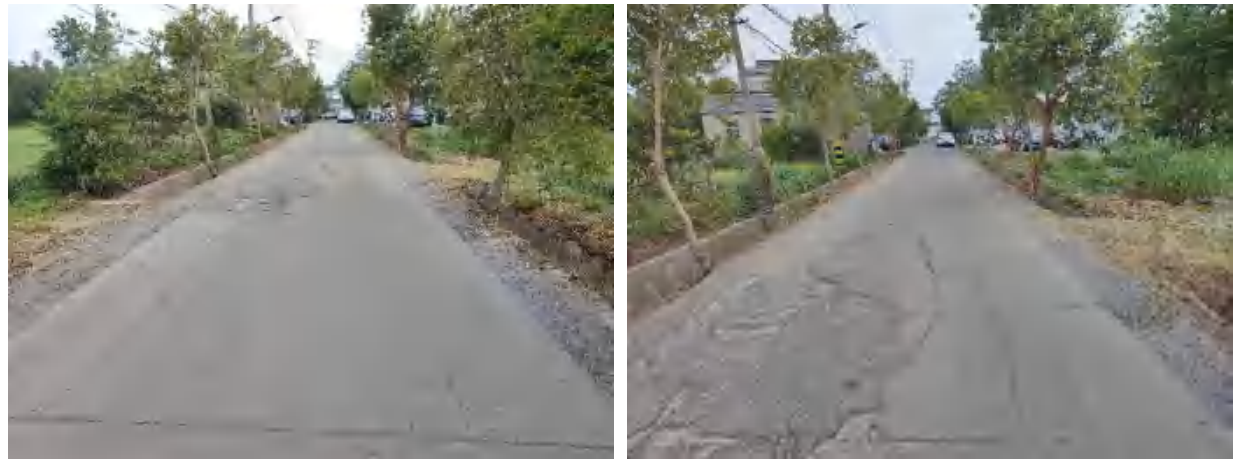
行车道破碎板起点（左）、终点（右） K0+590 处破碎板病害分布图：
