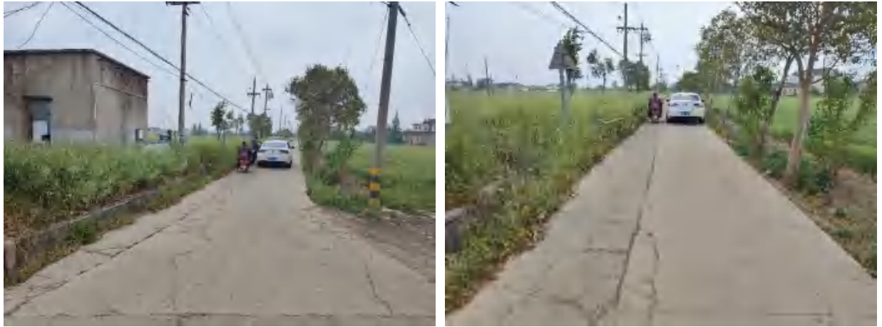
行车道破碎板起点（左）、终点（右） K1+250 处破碎板病害分布图：
