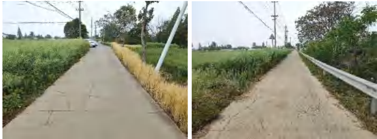
行车道破碎板起点（左）、终点（右） K1+352 处破碎板病害分布图：
