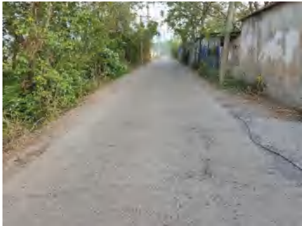
行车道板角断裂
