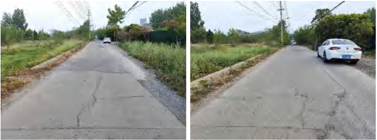
行车道破碎板起点（左）、终点（右） K0+690 处破碎板病害分布图：
