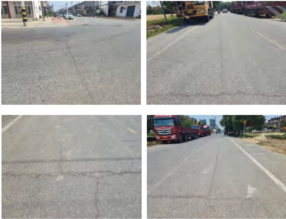
沥青混凝土裂缝病害现状
