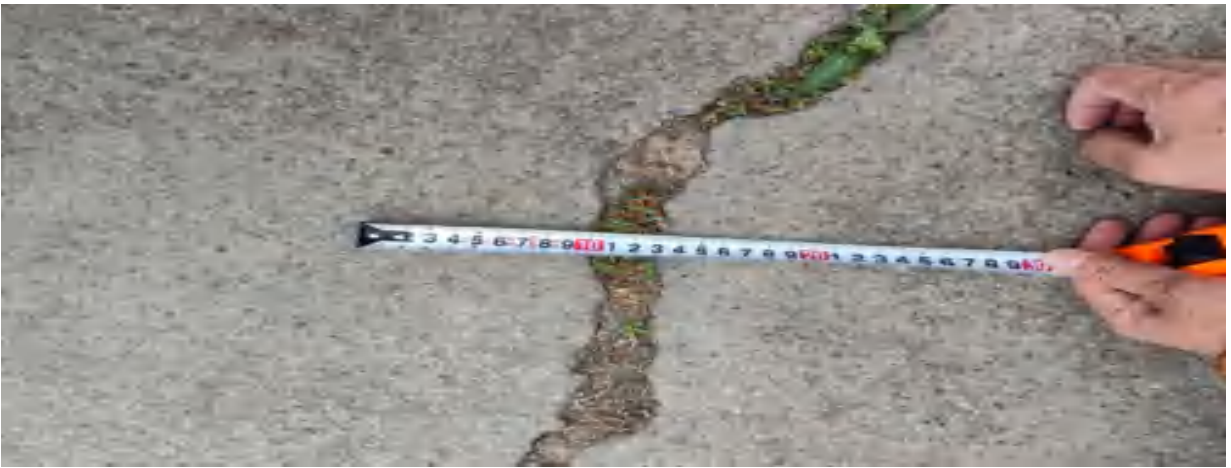
水泥混凝土裂缝病害现状
