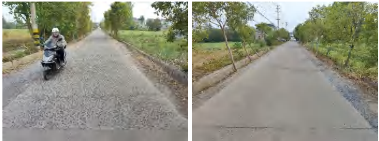
行车道破碎板起点（左）、终点（右） K0+320 处破碎板病害分布图：
