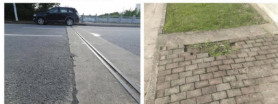
桥头搭板台下下沉
