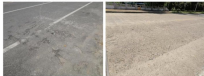
沥青混凝土桥面铺装坑槽
